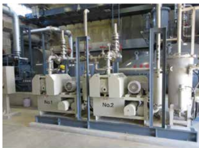
写－4 乾式真空ポンプ（満水系統機器）
