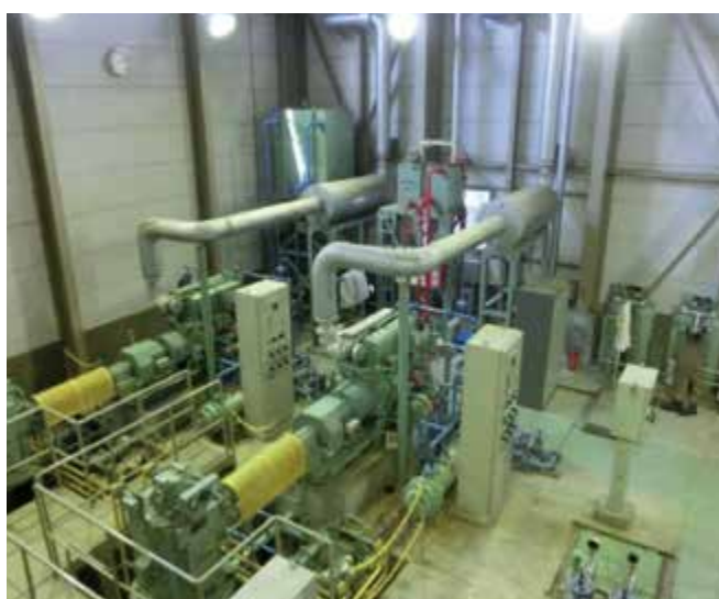
写－13 排水機場更新前（立軸ポンプ＋ディーゼル機関）
