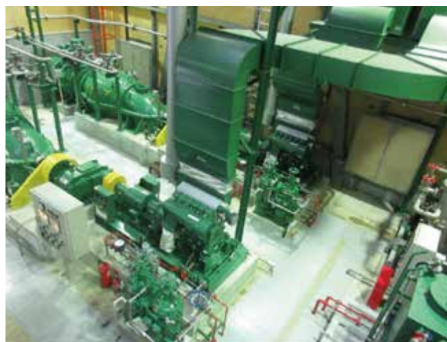
写－3 空冷ディーゼル機関（高砂排水機場）
