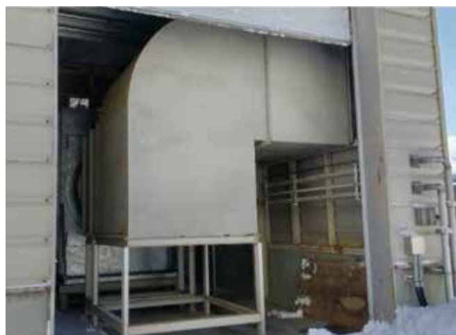
写-6 別置ラジエータ（月寒排水機場）
