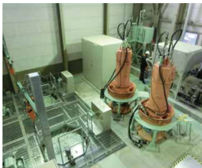
写－14 排水機場更新後（コラム形水中ポンプ＋自家発電機）
