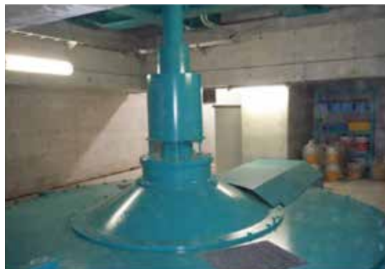
写－4 主ポンプ整備後
