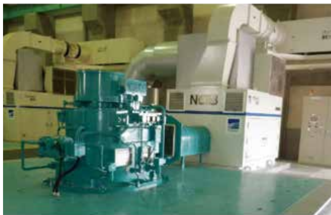
写－3 減速機更新後
