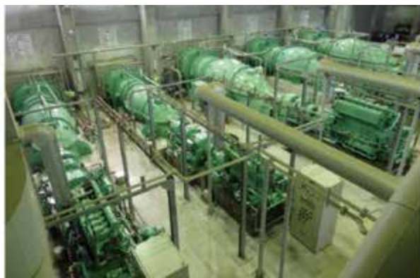
写真2 西川排水機場内（1～5号機）
