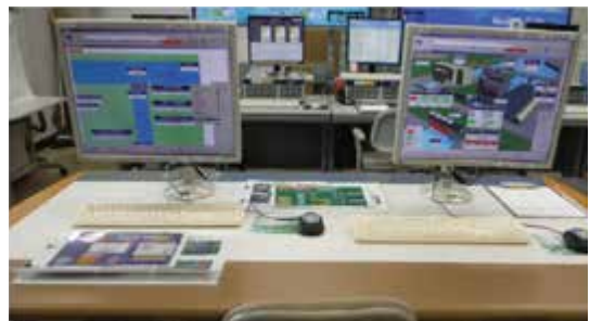
写-11 関屋出張所の遠隔監視操作装置
