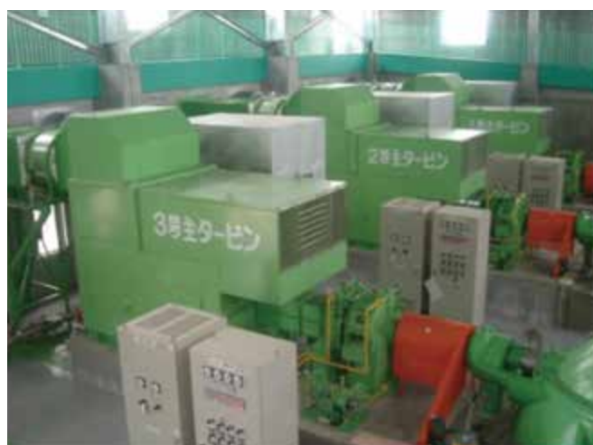
写－2 ガスタービン機関（南6号排水機場）
