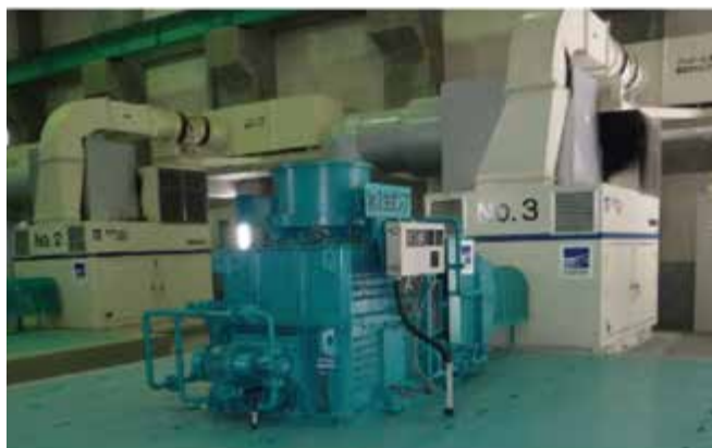
写－2 減速機更新前
