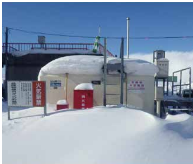
写－12 防油堤一体型燃料貯油槽
