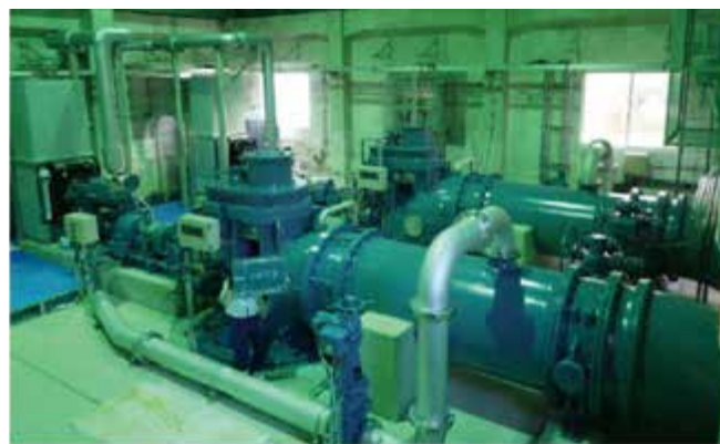
写－２ 学島排水機場設備全景（工事後）
