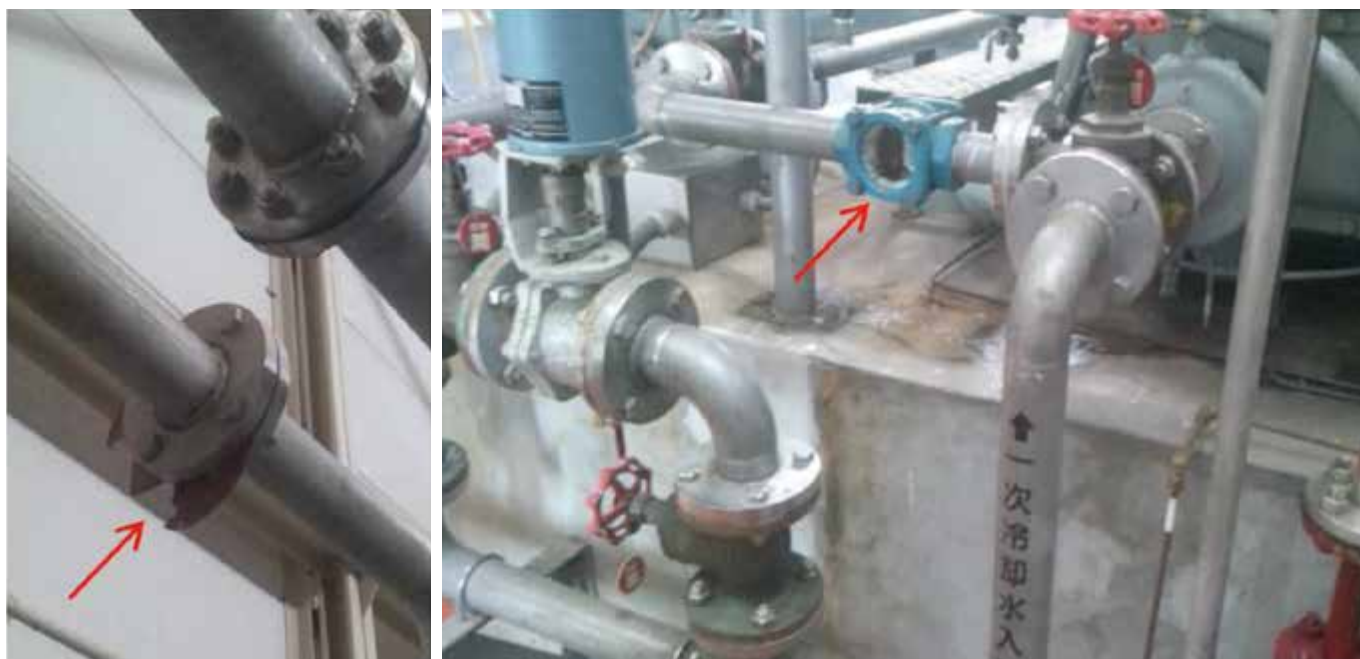
写－9,10 小配管凍結破損状況（美登位排水機場）パッキンの破損及びフローサイトの破損
