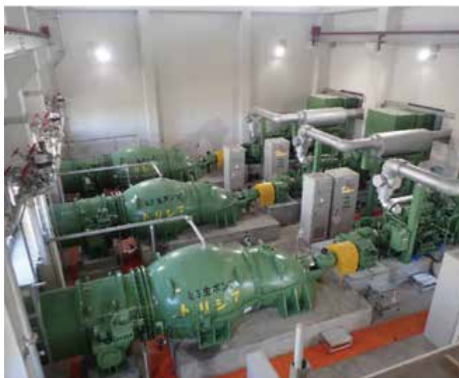
写－15 全台無水化後（帯広排水機場）
