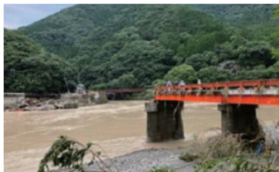
写-2 深水橋の流出 (R2年7月球磨川)
