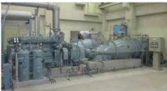
写－1 郷分排水機場機械設備
