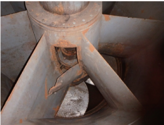
図- 21 ポンプ内部状況
