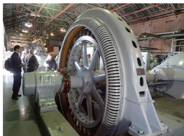
図－5 第6ポンプ場 ポンプ・電動機
