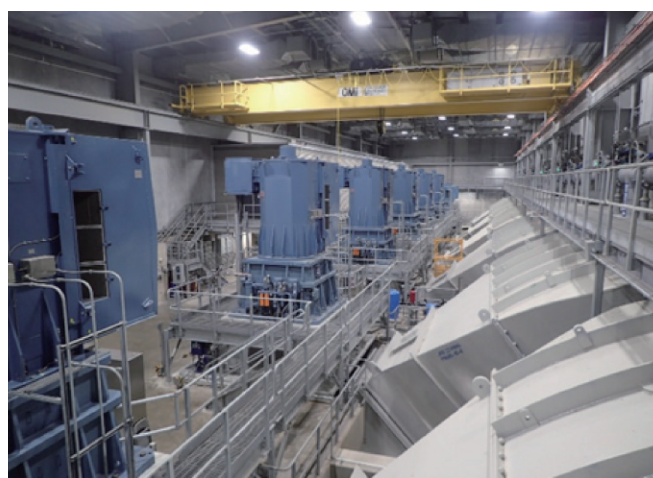
図ー10 電動機室
