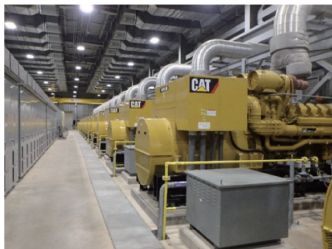
図ー11 自家発電設備
