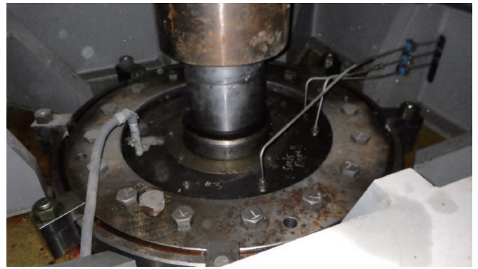
図ー 14 ポンプに取り付けられた振動センサ
