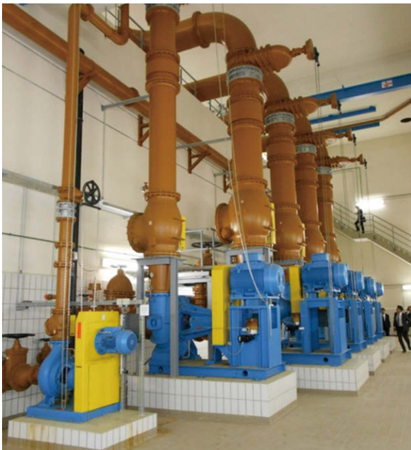
写－3 ポンプ設備 設置状況
