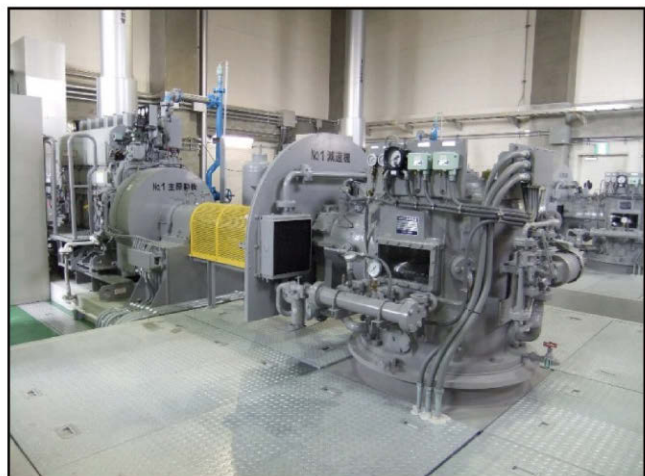
写ー2 豊岡排水機場の主原動機と減速機
