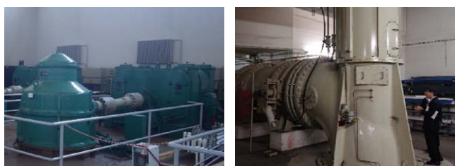
写－6 電動機、減速機、立軸斜流ポンプ
