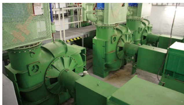
写－5 横軸渦巻ポンプ
