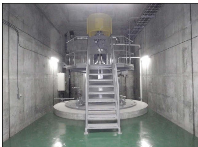
写ー3 豊岡排水機場の主ポンプ
