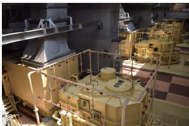
写－3 ポンプ室全景 (50 m 3 / s × 4 台)
