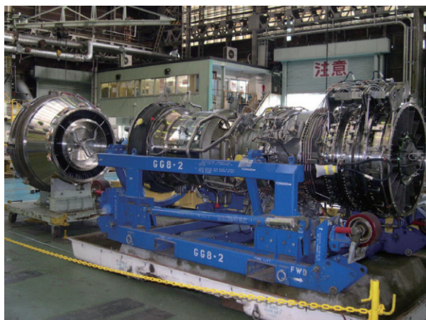
写－4 主原動機 (10,300kW ガスタービン)
