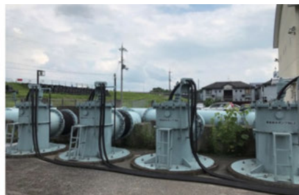
写真 15 弘法川既設緊急排水ポンプ設備
