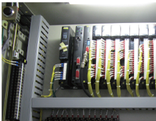
図－５ 補助継電器盤（PLC 形）
