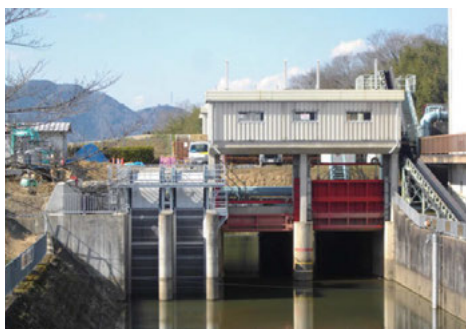
写真 13 緊急排水ポンプ設備 3.0m³/s
