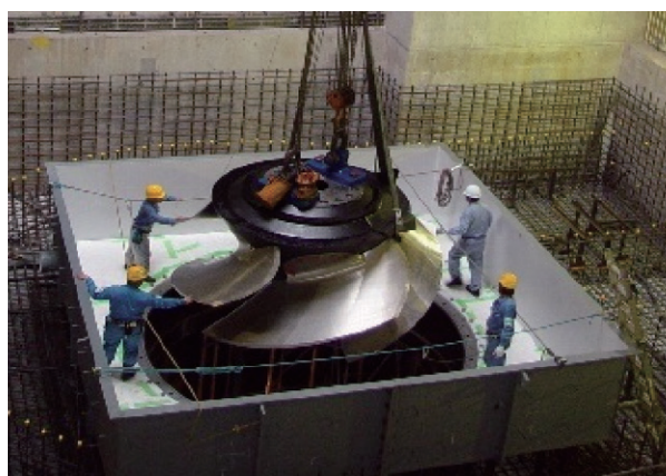
写－5 主ポンプインペラ (全揚程 14m、50m 3 /s)
