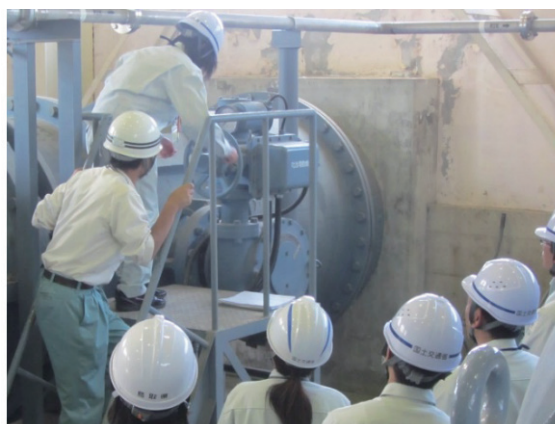
写 2 - 2 吐出弁異常時の対応（手動による開閉操作）
