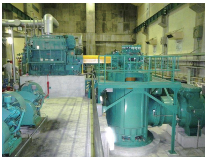
写－7 平井排水機場（倉安川排水ポンプ）
