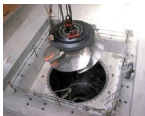
世界最大級の排水ポンプ設備
