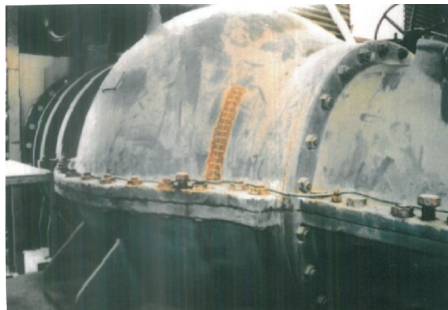
写-2 横軸ポンプ外観
