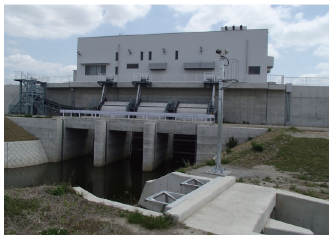
写-4 除塵機外観
