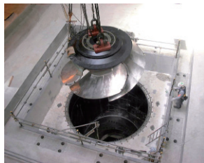
世界最大級の排水ポンプ設備
