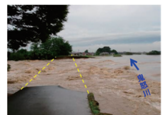
写－5 堤防決壊箇所拡大
