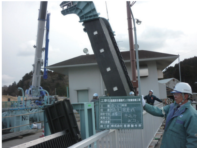
写－4 除塵機一体での設置状況
