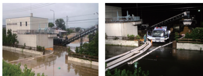
写一 14 栃木県小山市 杣井木排水機場での排水状況
