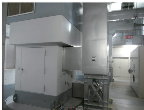
写－5 立軸ガスタービン
