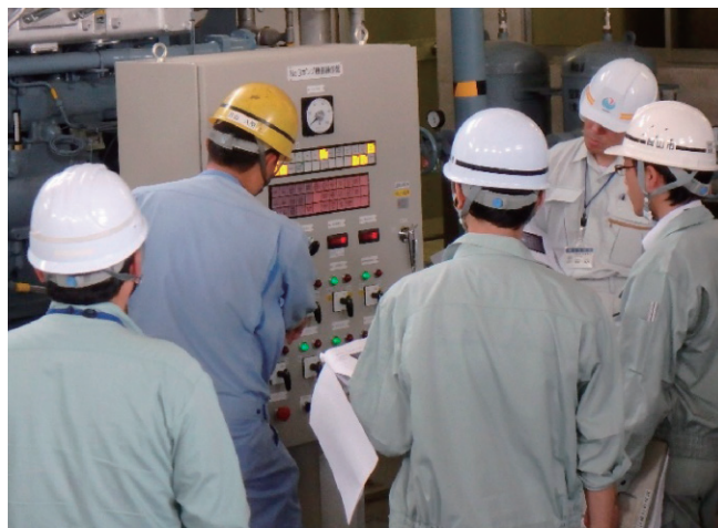
写 2-1 機側操作盤における単独運転操作
