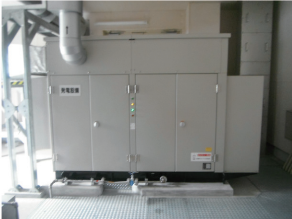
写－6 空冷式発電機
