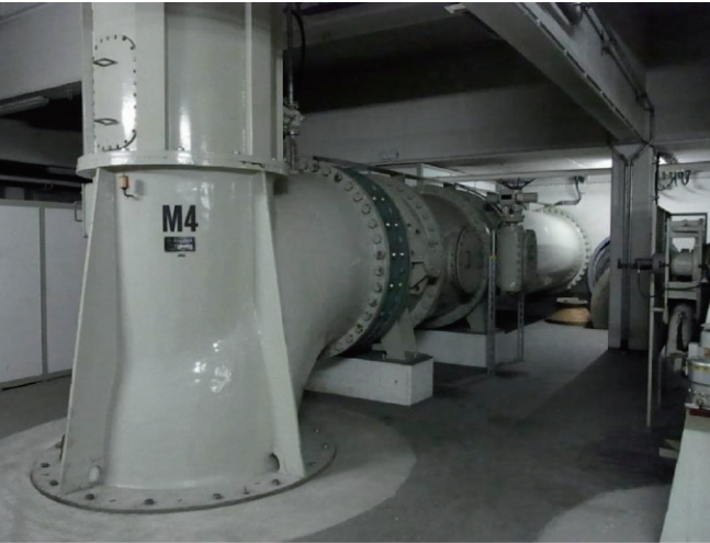
写ー8 B排水機場 立軸斜流ポンプ
