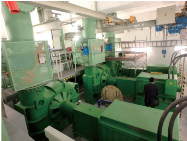
写－7 A排水機場 横軸渦巻ポンプ
