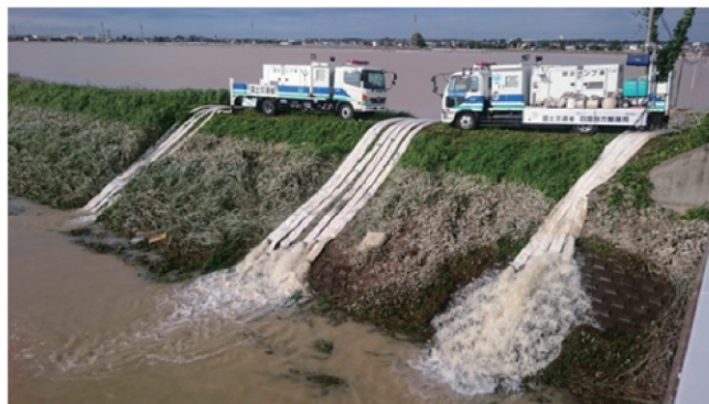
写－9 大橋周辺での排水状況
