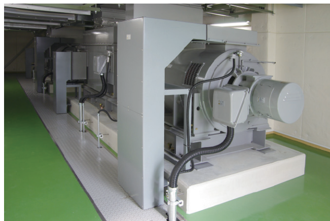
図－4 制御盤、MGセット
