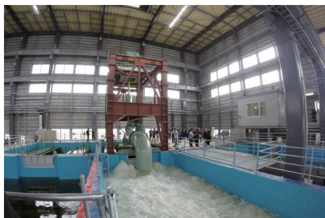
立軸斜流ポンプφ1000mm運転状況
