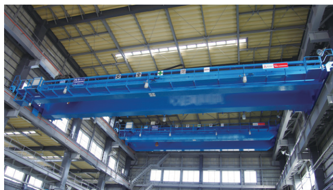
図-2 天井クレーン
