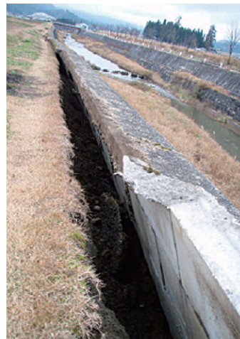
姫川護岸被害
