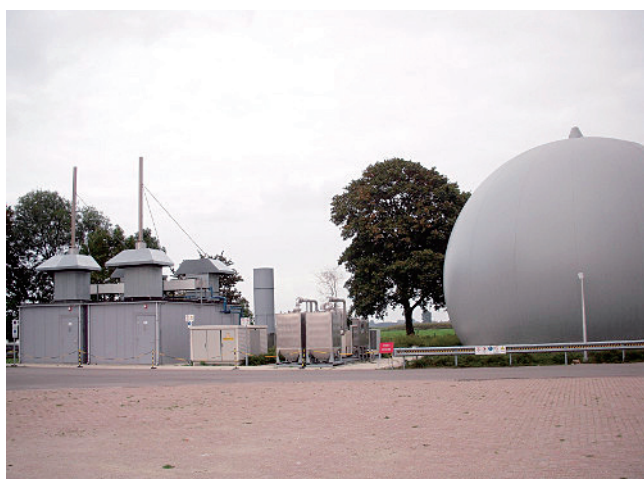
写－4 消化ガス発電施設
