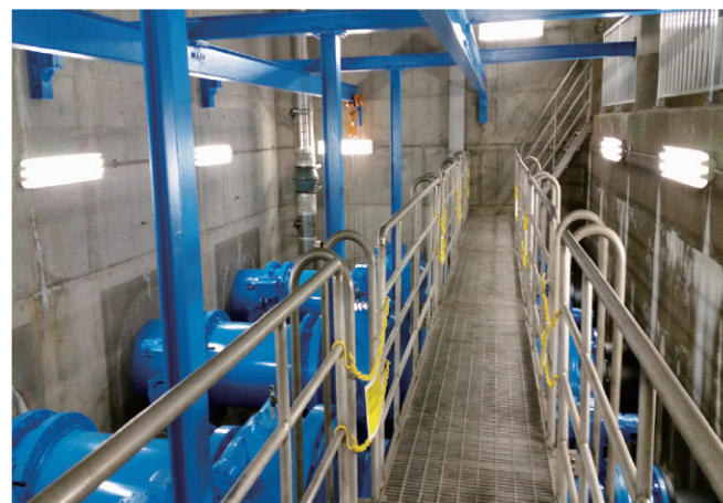
写－17 簡易クレーン設備
