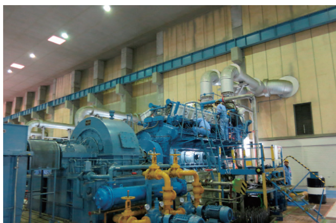
写-11 ポンプ設備試運転状況
