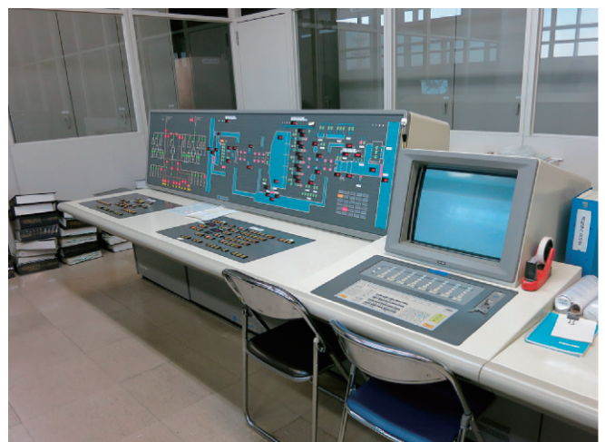
写－7 北千葉第二機場操作室
