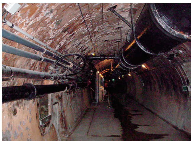
写－8 下水道幹線内の各種配管
