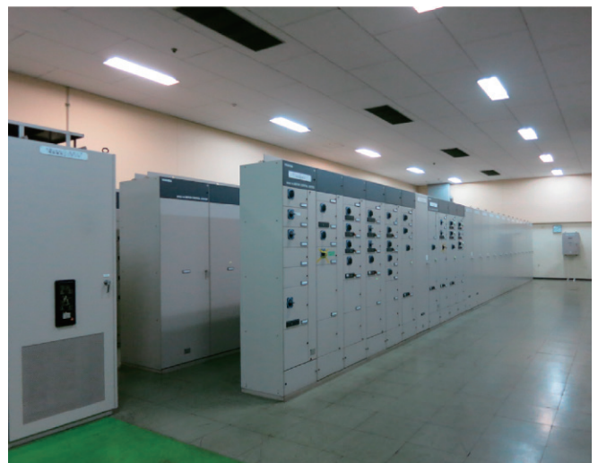
写－8 北千葉揚排水機場 制御盤室 PLC 盤
