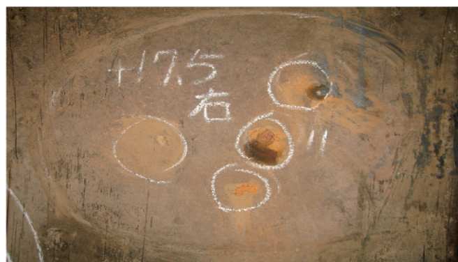
写－19 埋設管の腐食
