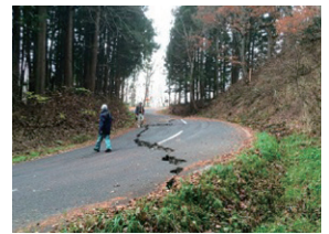
国道406号土砂崩落
