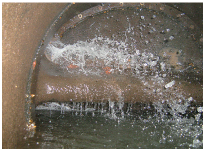
写－15 逆止弁漏水状況
