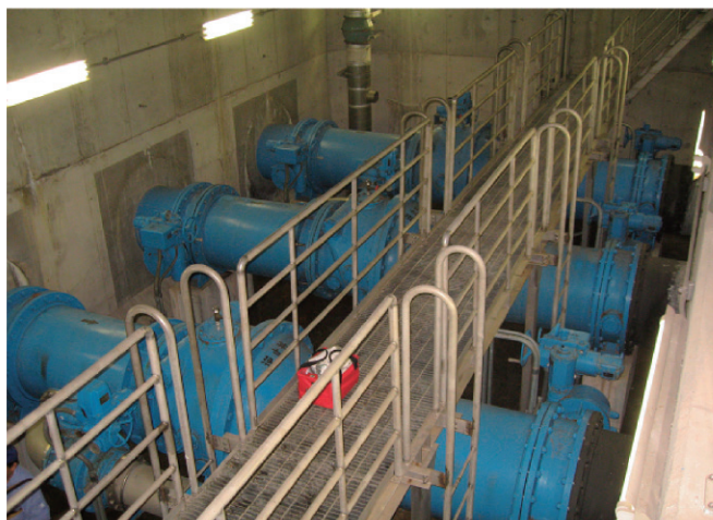
写－13 サージタンク配管
