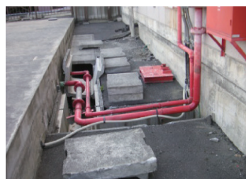
写－11 不同沈下対策で被害を免れた燃料配管 (東日本大震災)
