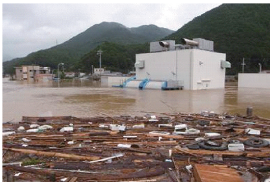
写－4 堤防越水により浸水した機場
