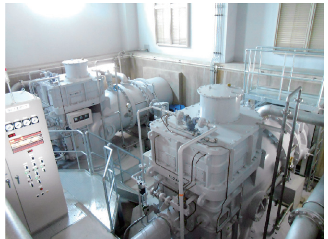
写－２ 機場内主ポンプ設備
