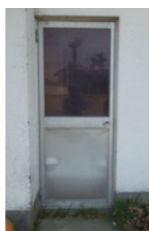
写－9 施設の水密構造化 (通用口の防水扉)
