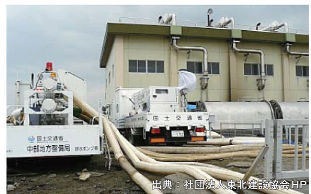
写－1 危機発生時の対応（排水ポンプ車による排水）
