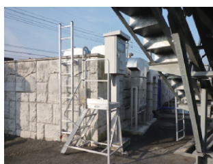
写－6 機器の高設置化 (除塵機操作盤)
