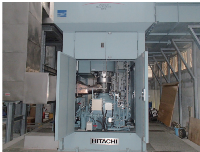
写－ 6 3号ポンプ用駆動設備 (ガスタービン)
