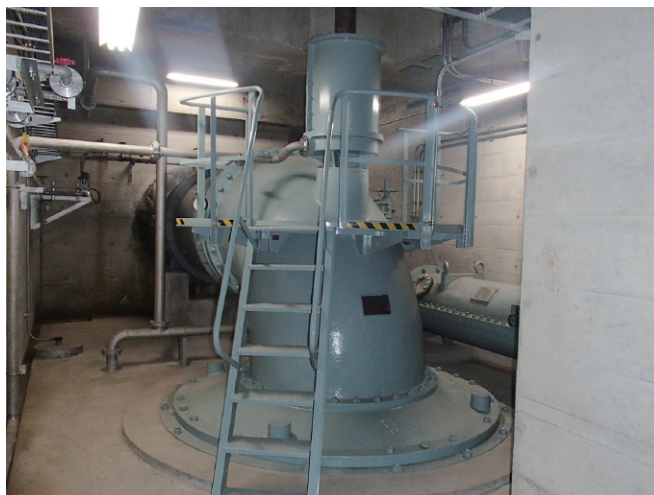
写－ 4 1号主ポンプ設備 (5m³/s)
