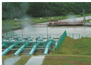
写－12 コラム形水中ポンプによる小規模機場
