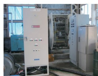
写－2 危機発生時の対応 （仮設操作盤による運転制御）
