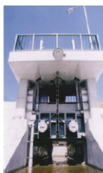
写－13 ポンプゲート
