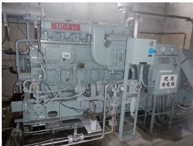
写－7 電源設備（常用発電機）
