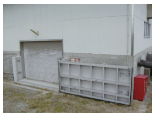
写－8 施設の水密構造化 (機器搬入口の防水扉)
