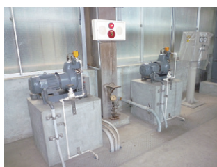
写－5 機器の高設置化 (真空ポンプ)
