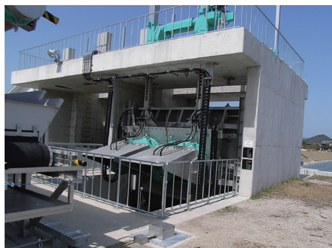
田尻川排水機場
