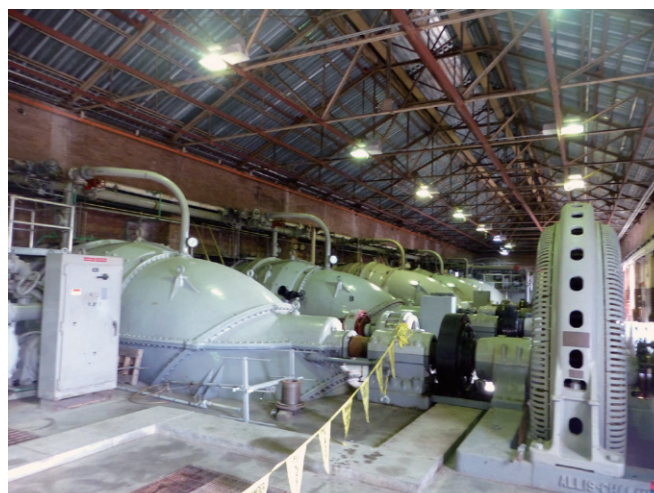
写－10 第6ポンプ場 ポンプ・電動機
