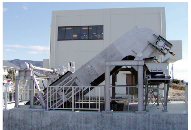
自動除塵機 引き上げ時
