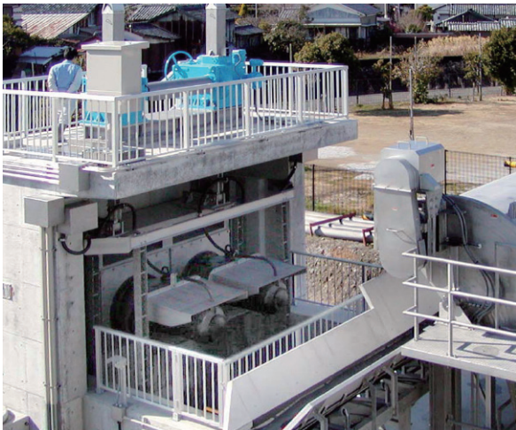
ポンプゲート用ゲート
