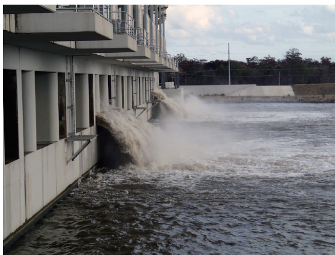
写－3 ポンプ試運転中（吐出側）
