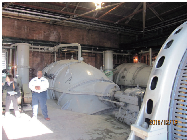
写－7 第1ポンプ場 ポンプ
