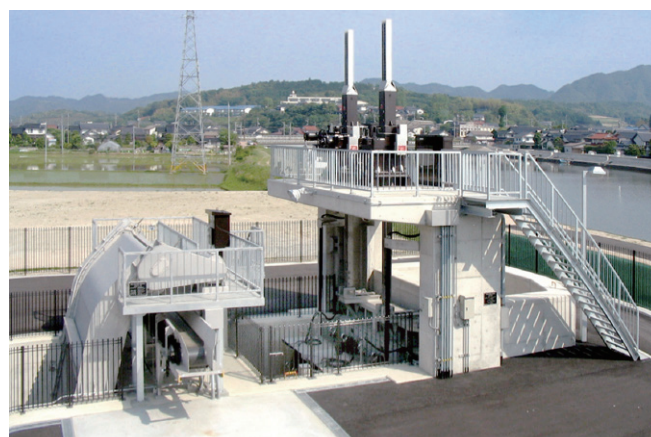
宍道湖湯谷川排水機場
