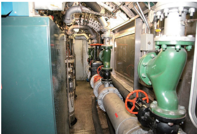
写－18 ポンプ列車内部（出典：MTA）
