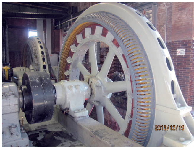
写－8 第1ポンプ場 電動機
