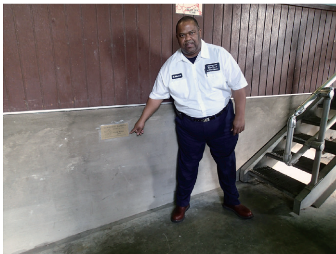
写－11 第6ポンプ場 浸水レベル
