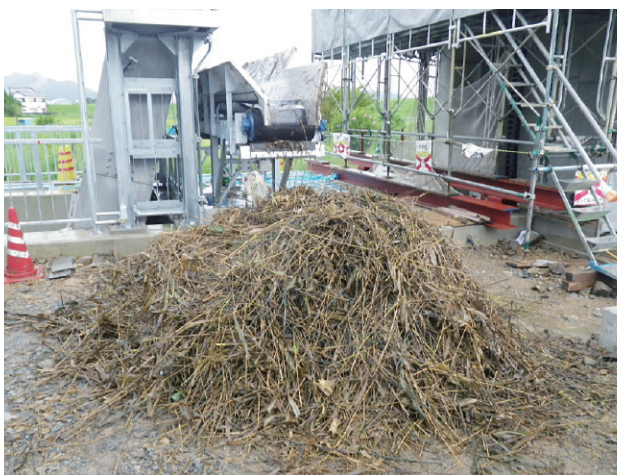
写－16 塵芥除去状況（除塵機）
