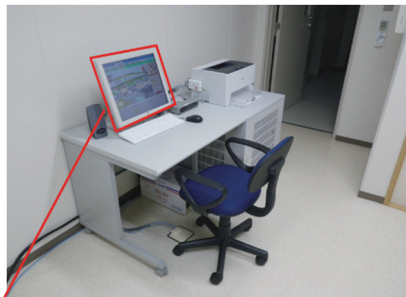
写－９ 遠隔監視端末（電気室内）
