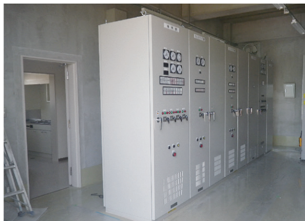
写－８ 各種制御盤（電気室内）
