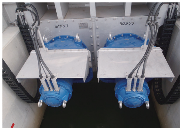
写－５ 水中ポンプ全景
