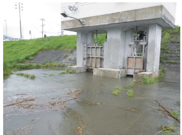
写－18 ポンプ稼働状況（外水側）
