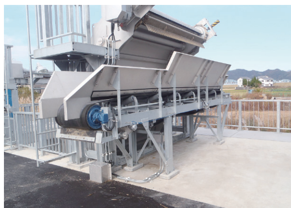
写－７ 水平コンベヤ全景
