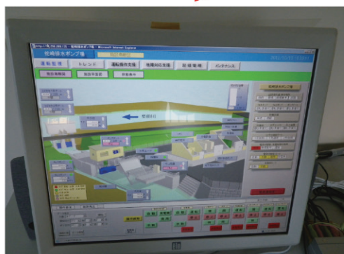
写－１０ 蛇崎排水機場監視画面
