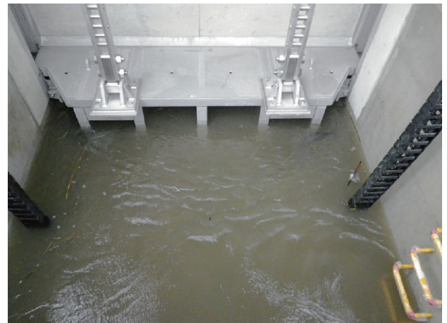
写－17 ポンプ稼働状況（内水側）
