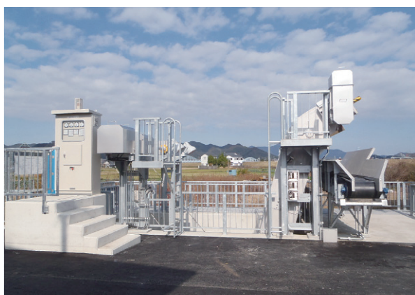
写－６ 除塵設備全景
