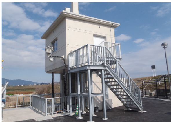
写－４ ポンプゲート設備全景
