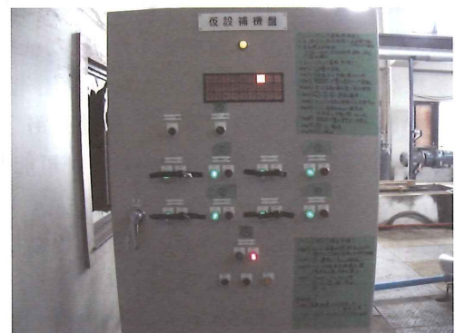
写-11 仮設盤（運転操作手順を明記）
