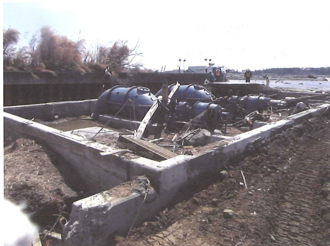
写－4 上屋が消失した機場
