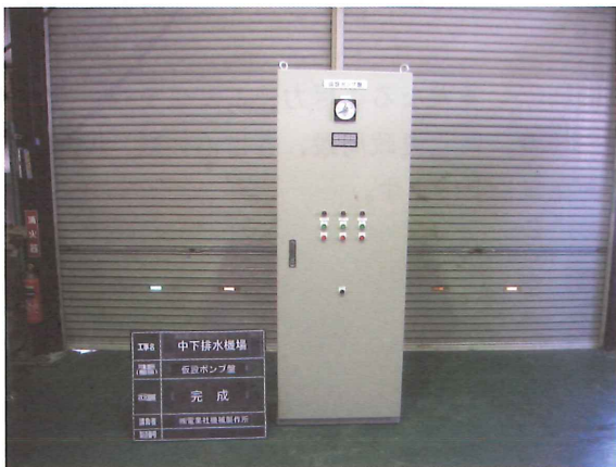
写-6 配電盤の一例
