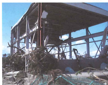
写-9 側壁が流出した機場
