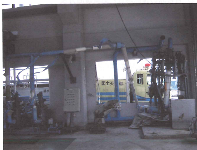
写－5 屋内小配管の破損状況
