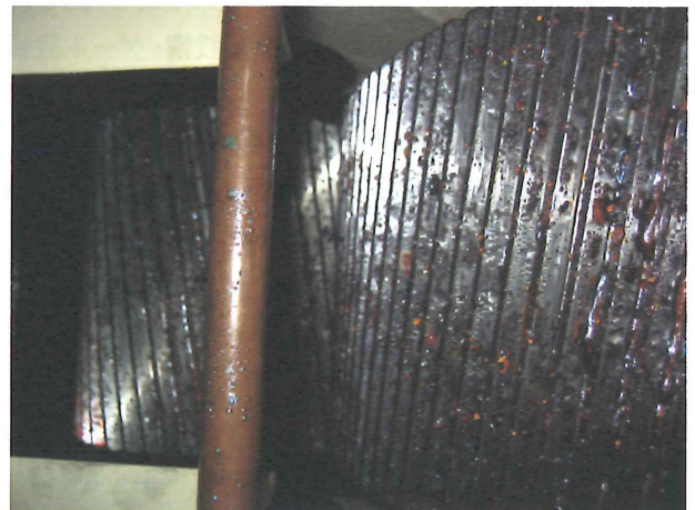
写-8 減速機歯面の発錆状況
