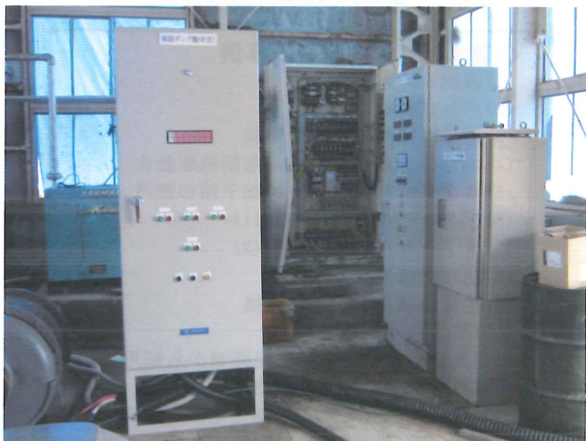
写-4 仮設操作盤による操作 (運動操作回路を省略し製作期間を短縮)
