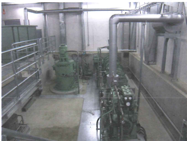
写－4 震災前のポンプ設備
