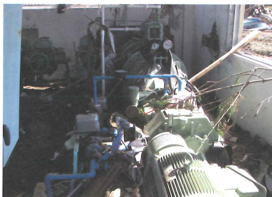
写-3 被災機場の一例
