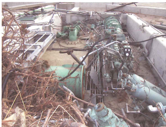
写-3 ポンプ状況
