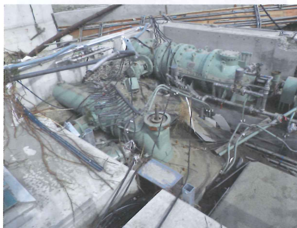
写－2 ポンプ室 (上屋が流失してしまったため、ポンプが土砂にまみれ雨ざらし状態で鎮座している)
