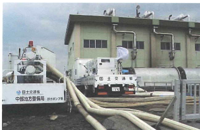
(社団法人東北建設協会 HP より) 写-7 東日本大震災における排水機場での排水状況
