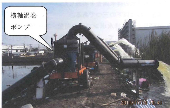
写-4 ①φ 200 移動式横軸渦巻斜流ポンプ
