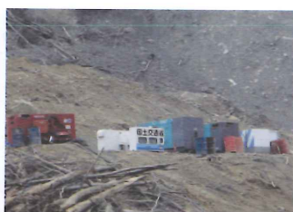
写－23 発動発電機の設置状況
