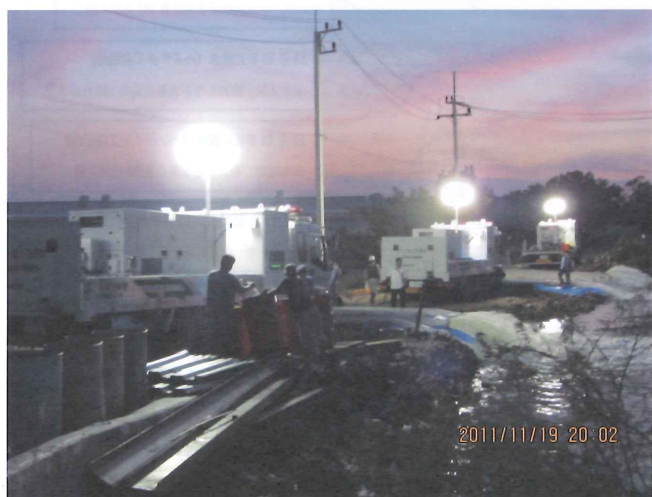
写-2 昼間・夜間の排水ポンプ車運転
