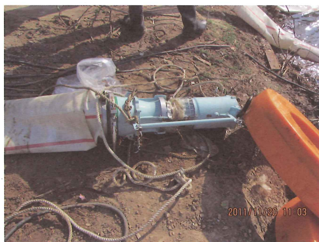
写—8 ポンプ吸込口にビニールの詰まり
