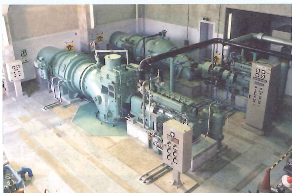
写真左: 減速機搭載型立軸ポンプ 写真右: 横軸ポンプ
