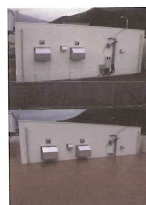
写－ 15 相野谷川排水機場の浸水①
