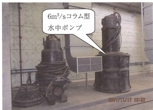
写ー10 φ1600水中ポンプ (6ton/s)
