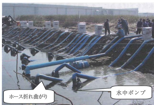
写-6 ③φ 150 水中ポンプ
