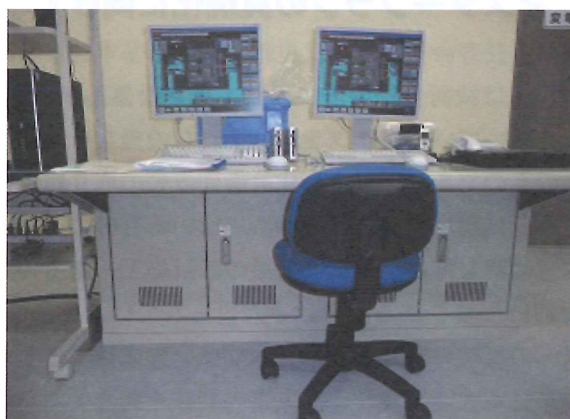
写－4 CRT監視操作卓
