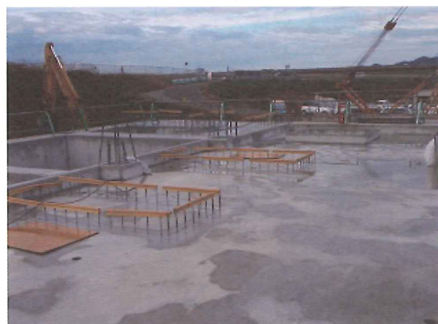
写真-5 平成21年10月初旬の原動機床
