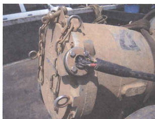
ケーブルの破損
