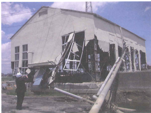
写－３ 津波がポンプ室を通り抜けた機場
