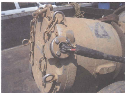
③ ケーブル損傷状況
