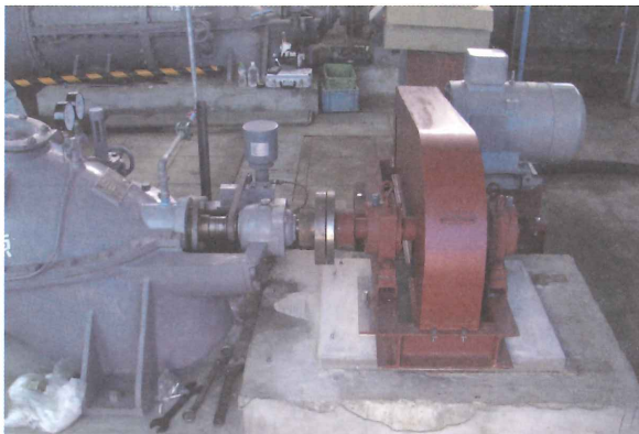
写一 7 仮設電動機とベルト駆動変速で仮復旧 (汎用電動機のため、ポンプと回転数が合わない)
