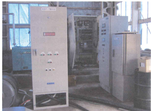
写一 9 仮設の操作盤
