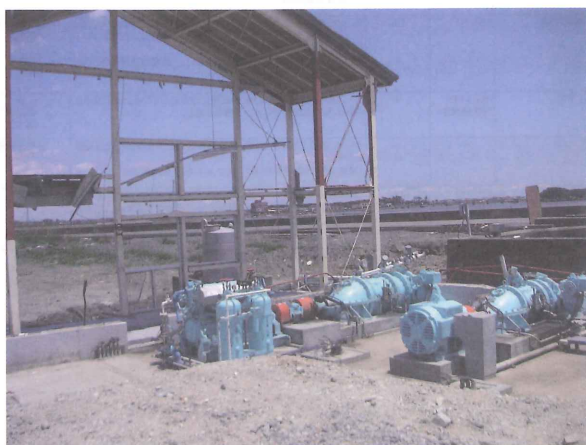
写－２ ポンプを残して上屋が流失した機場
