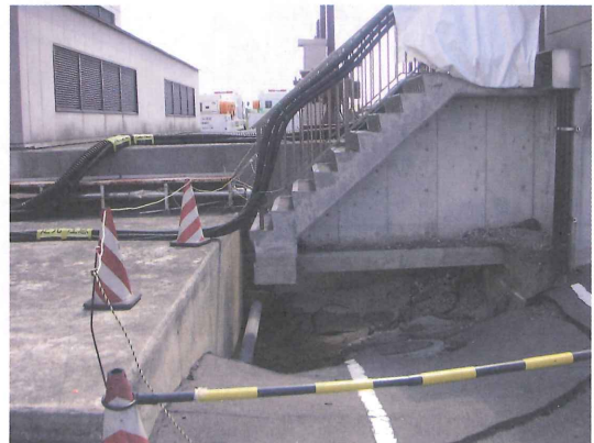
写－1 排水機場周囲の不等沈下
