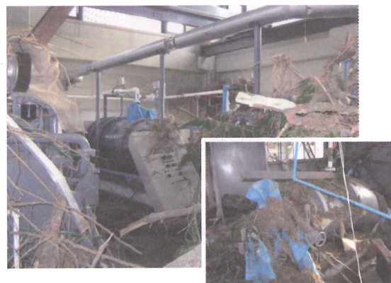
写－６ ポンプ室に流入した塵芥・ガレキ
