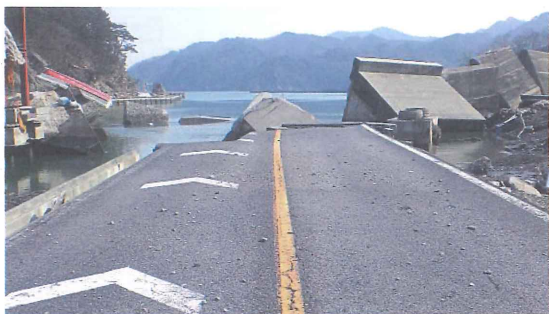
国道45号釜石市両石地区道路流失
