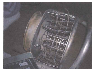
ストレーナの破損
