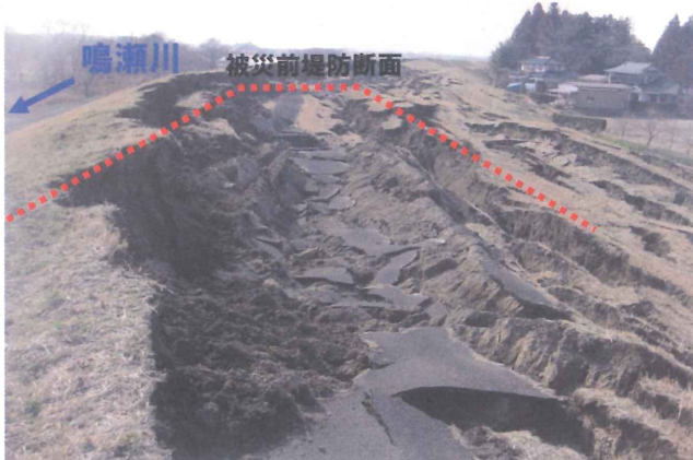
鳴瀬川（下中ノ目地区）堤防被災
