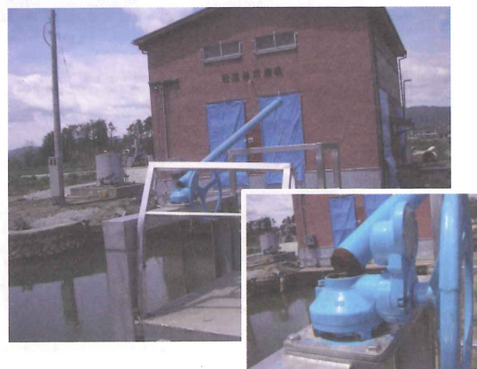
写－５ 開閉機スピンドルが折れ曲ったゲート
