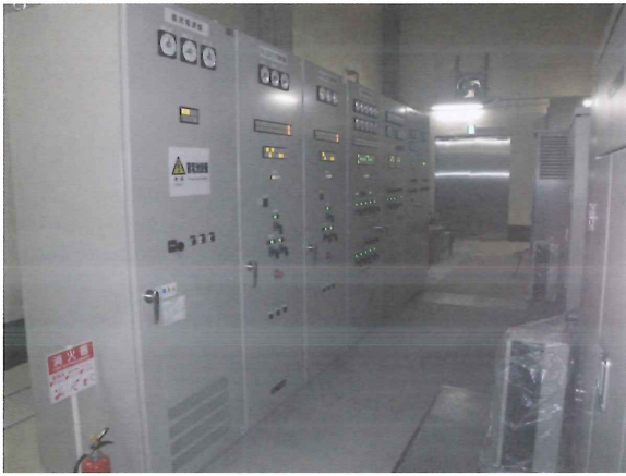
写一4 機側操作盤
