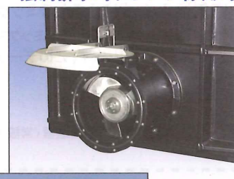
強制排水時 / ポンプ稼働時
