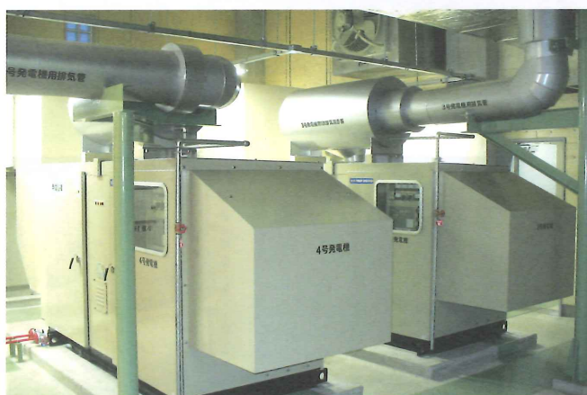
図一12 自家発電装置（設備用）
