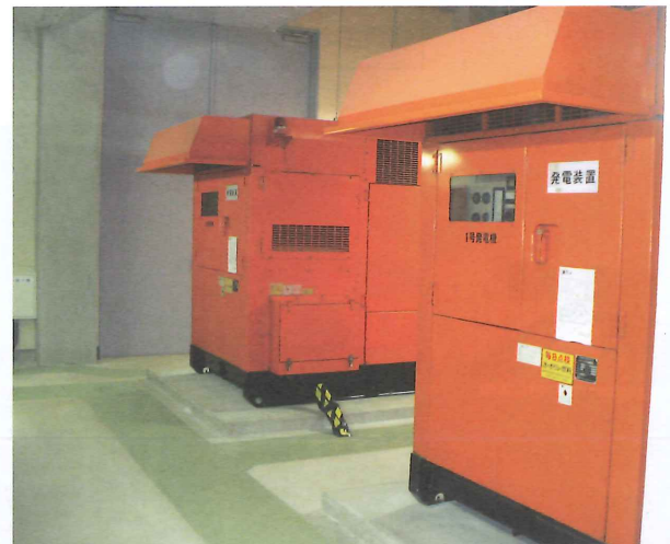
図一13 自家発電装置（救急排水用）
