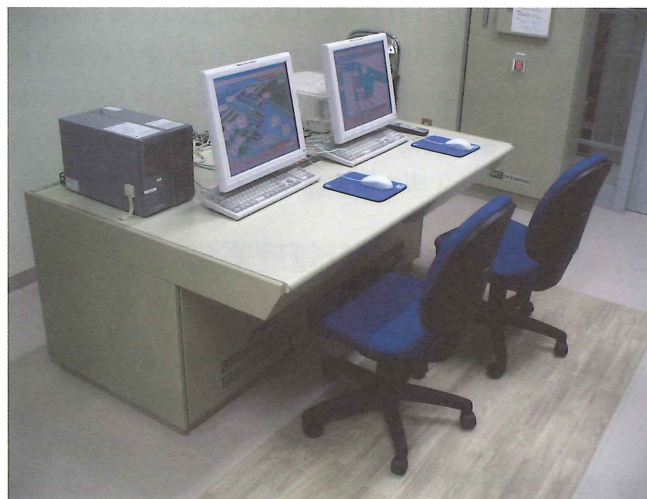
図-10 監視操作卓
