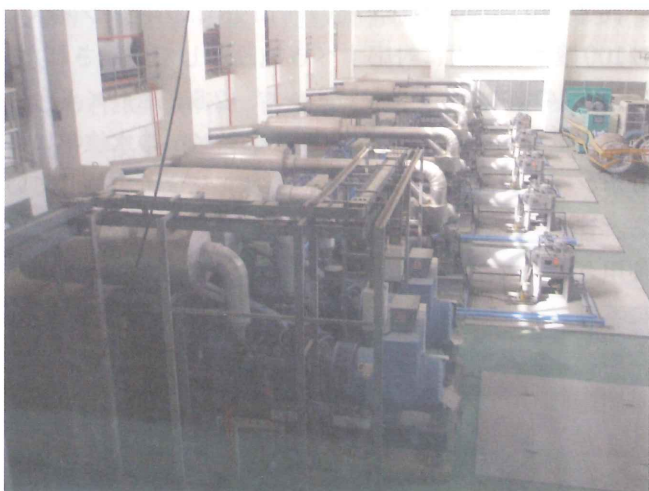
写－3 南部科学工業園区内ポンプ所
