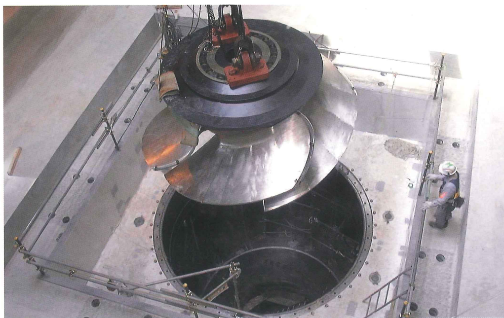
「関東地方整備局 江戸川河川事務所 庄和排水機場向け排水ポンプ」
