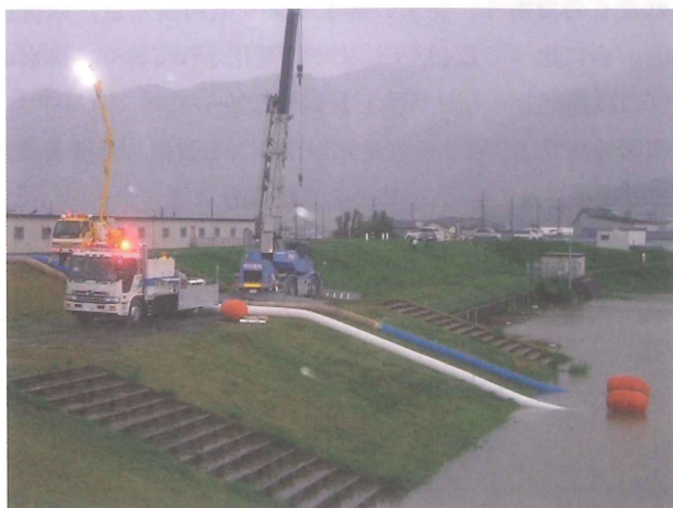
写一七 排水ポンプ車設置状況
