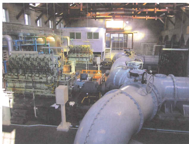
写一5 現在の犀川第一排水機場内部
