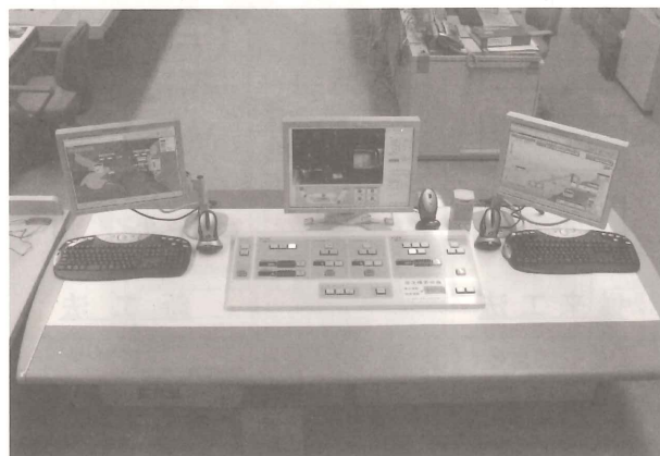
写真-4 監視操作卓
