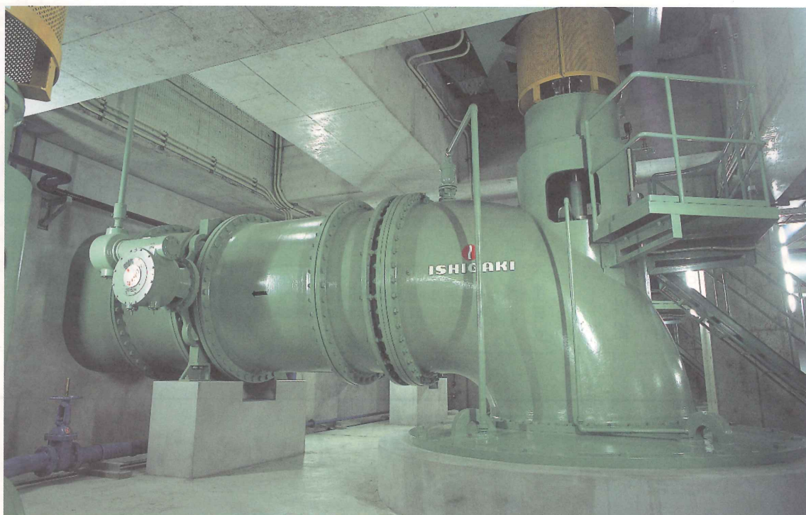
日本下水道事業団/山口市下郷雨水ポンプ場納入 上段:下郷雨水ポンプ場全景写真 下断:下郷雨水ポンプ場据付写真 1800mm \times 450 \text{m}^3/\text{min} \times 7.05m \times 772kW 1台(全体計画2台) 700mm \times 60 \text{m}^3/\text{min} \times 7.09m \times 110kW 2台
