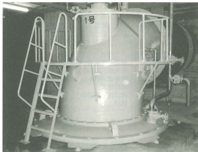
写-2 新水門川排水機場主ポンプ
