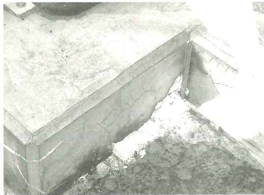
写真5 ポンプ基礎部のクラック
