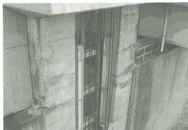
写真2 堰の門柱被害(平成16年新潟県中越地震、妙見堰)
