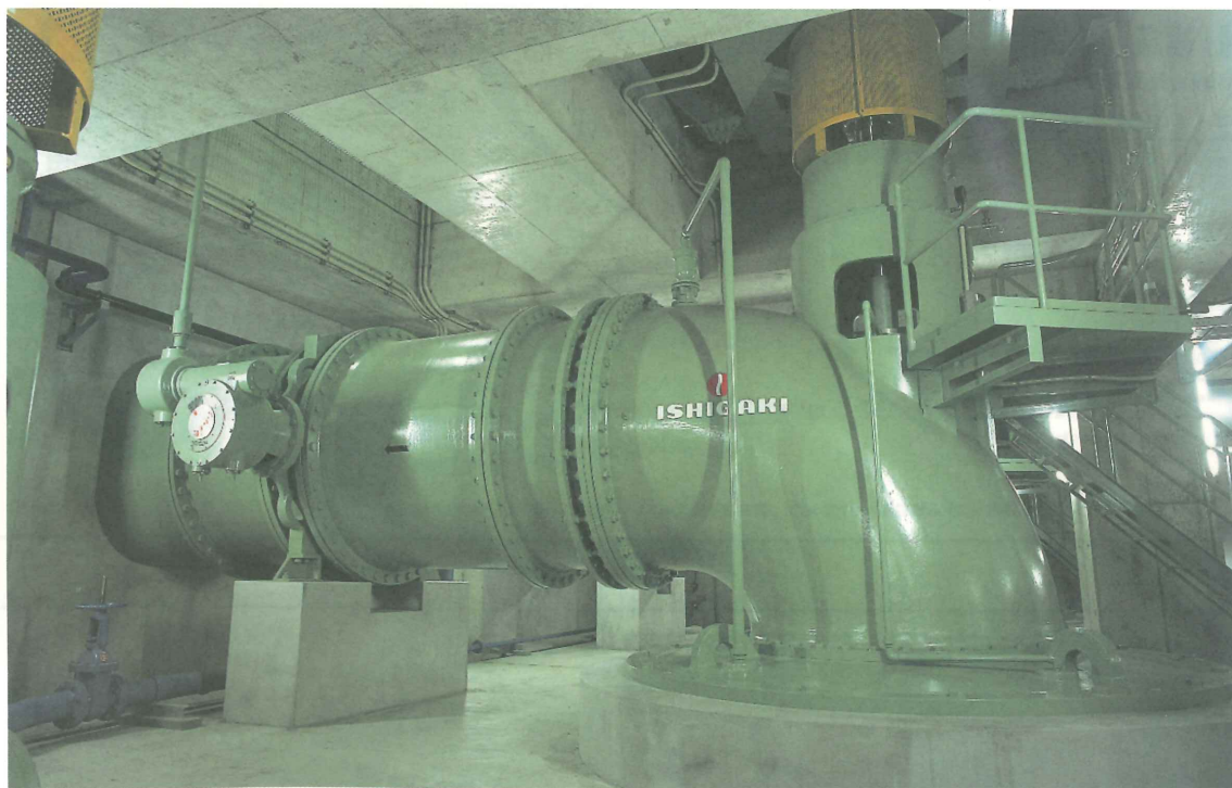
日本下水道事業団/山口市下郷雨水ポンプ場納入 上段:下郷雨水ポンプ場全景写真 下断:下郷雨水ポンプ場据付写真 1800mm \times 450m 3 /min \times 7.05m \times 772kW 1台(全体計画2台) 700mm \times 60m 3 /min \times 7.09m \times 110kW 2台
