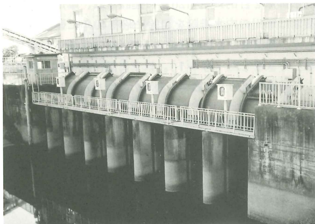
写-4 自動除塵機
