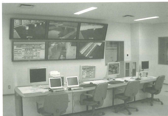
写-4 監視操作設備
