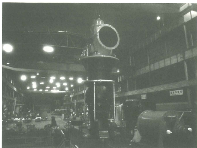
写一2 改造した主ポンプ
