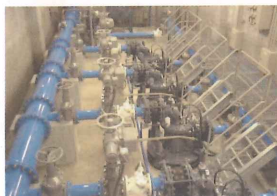
ポンプ室全景
