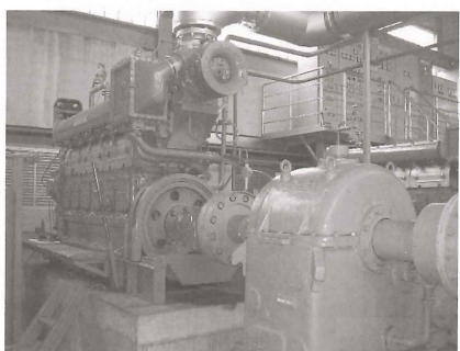
写真-7 豊岡排水機場 主原動機
