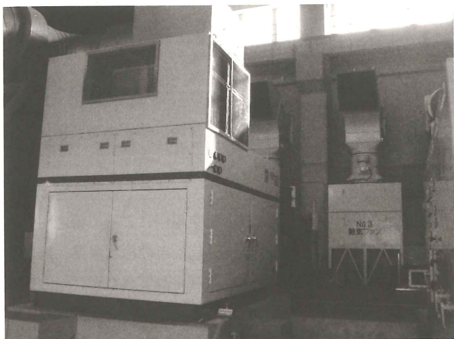
写一3 2号ポンプ（毎秒20m 3 排水） ガスタービンエンジン採用でコンパクト化と静粛化を図っている
