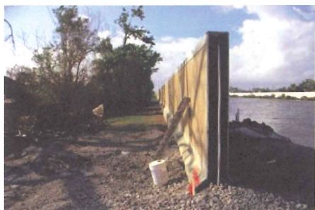
写一 破堤地点南側のI型floodwall
