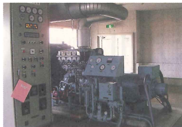
写-3 自家発電設備
