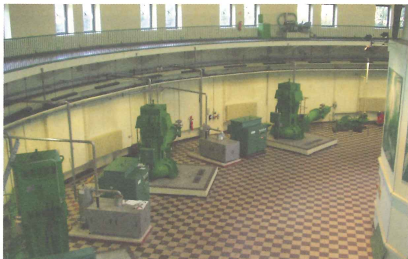
写一3 オールドエムシャーポンプ場内写真
