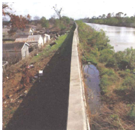
写六 傾いたfloodwallの堤外側に生じた水面 および傾いた小屋
