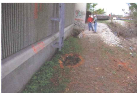
写五 傾いたfloodwallの堤内側の陥没
