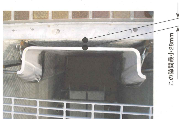
写一 既設コンクリートとの隙間状況
