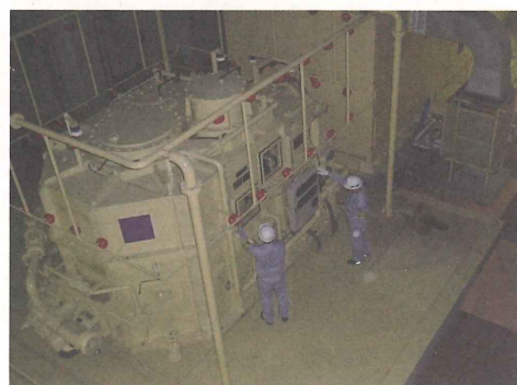
写二 排水運転時複合減速機点検中（原動機室）
