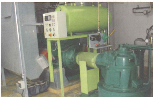
写一5 イゼナッハ=エッグバッハ地区ポンプ場内写真
