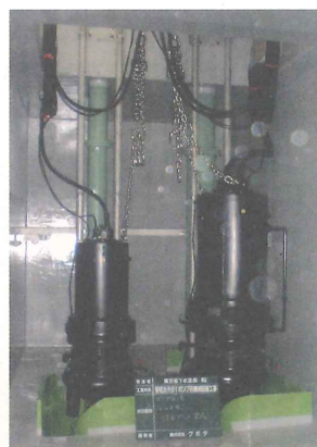
写-1 ポンプ外観
