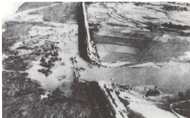
写-5 S28.6出水による破堤状況(植木地区)
