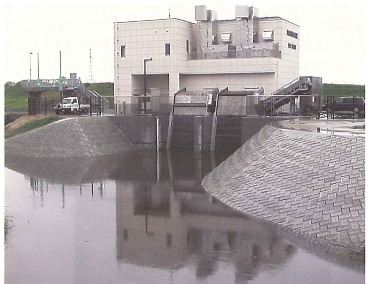
写一五 コンパクトな流入部と除塵設備
