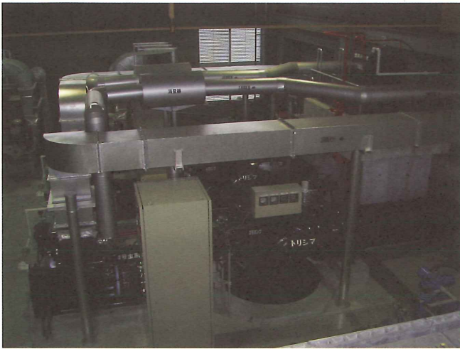
写一 機場内ポンプ設備
