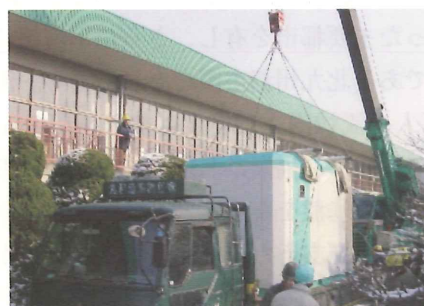
写-1 屋外仕様（テスト機）の設置風景
