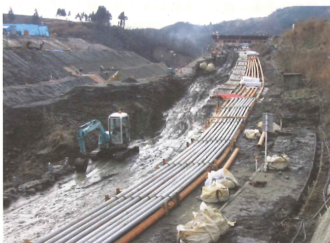
写-7 高揚程ポンプの配管
