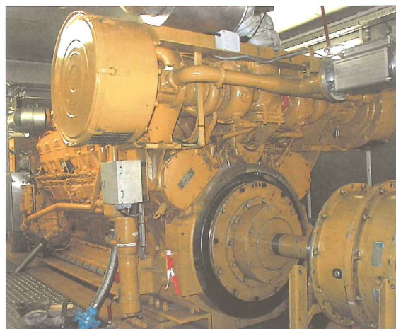
写一四 ガスエンジン
