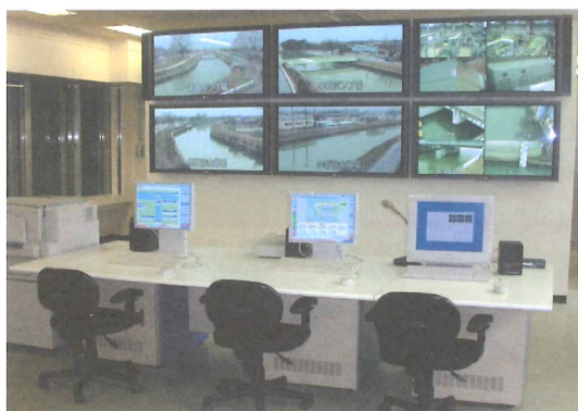
写ー2 操作室 運転支援装置
