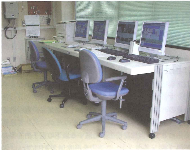
写一4 監視操作制御設備
