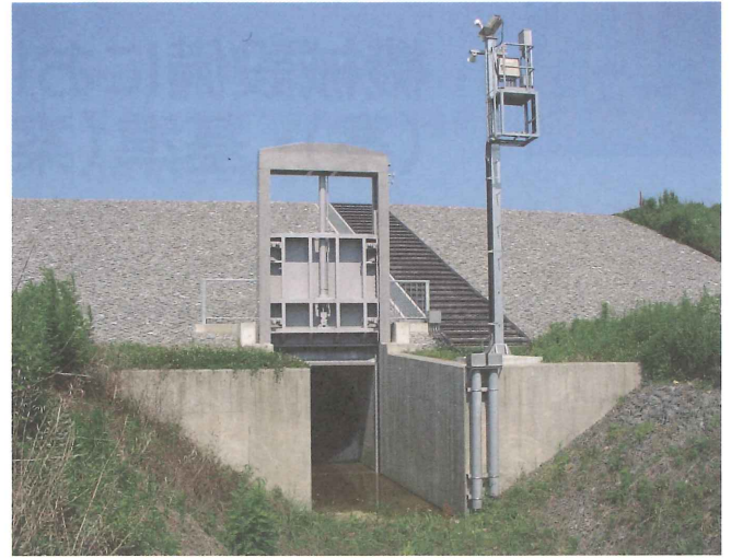
写一5 油圧シリンダ式吐出ゲート及びCCTVカメラ
