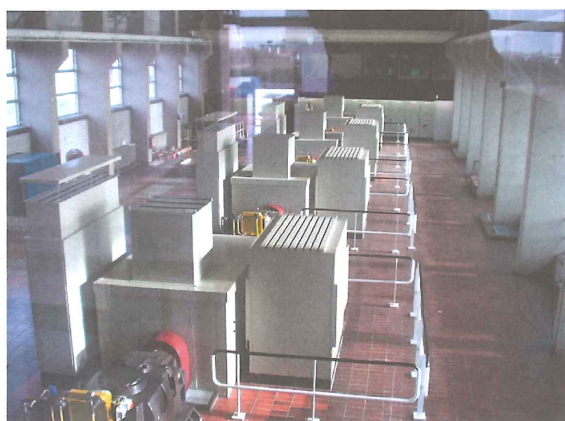
写一三 Helsdeur ポンプ場
