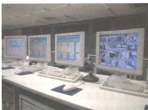
写真二 画像監視制御装置
