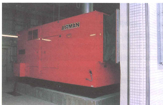
写一五 排水機場発電機室
