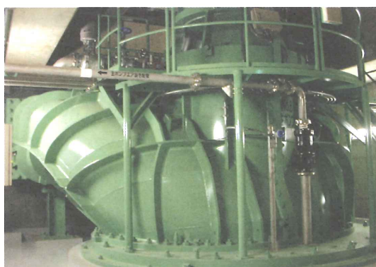
写ー1 西川第二排水機場 (立軸軸流ポンプ 25\text{m}^3/\text{s} )
