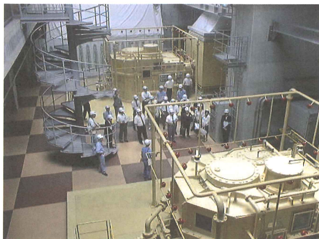
写-2 ポンプ室（前方はガスタービン、手前は減速機）
