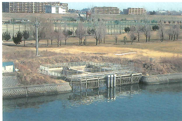
写－2 取水設備全景
