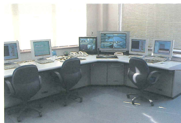
写－5 操作設備（機場側端末）
