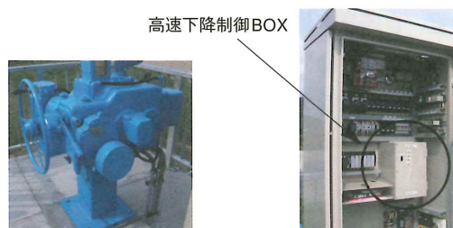
写一 ラック式開閉機
