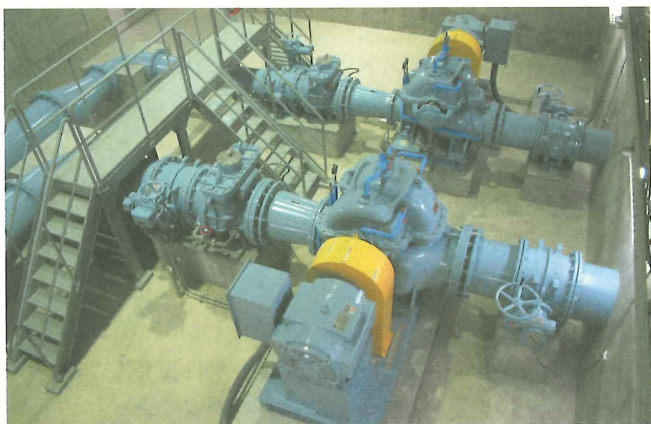
写-2 揚水ポンプ設備
