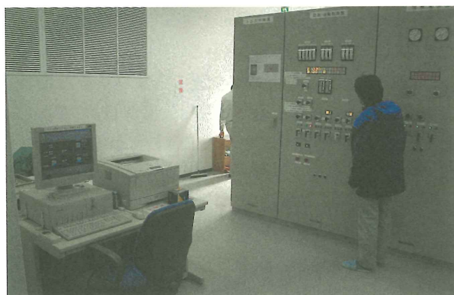
写-3 操作室（手前：監視操作卓）
