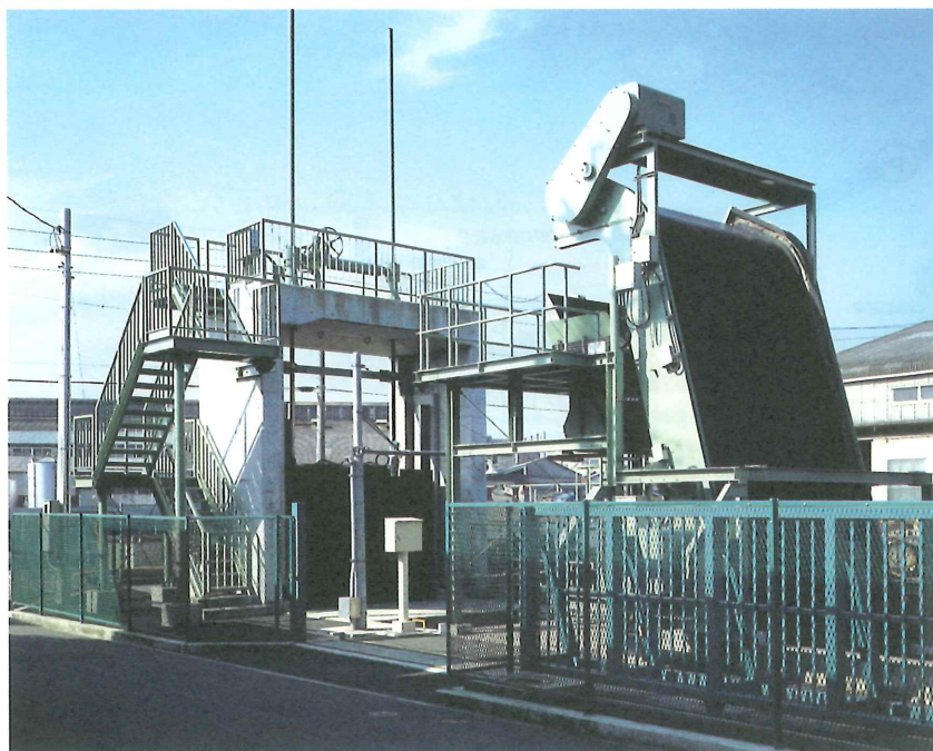
写-1 ポンプゲート式小規模排水機場の外観
