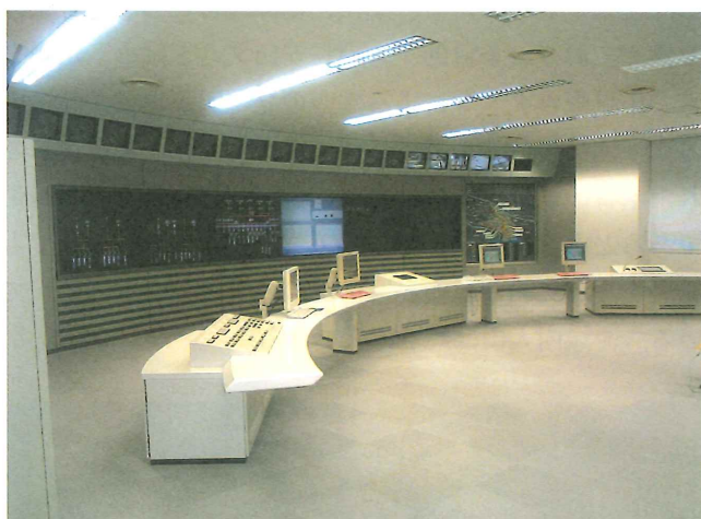
写－1 庄和排水機場中央操作室
