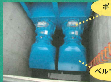
ポンプゲート本体
