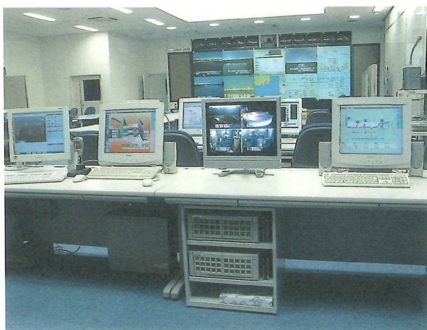
写一 9 遠隔監視操作設備（事務所側端末）
