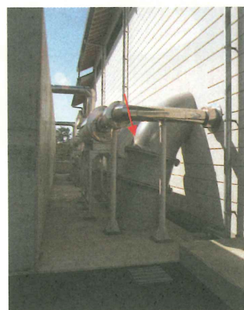
午頭川主ポンプサイフォン配管
