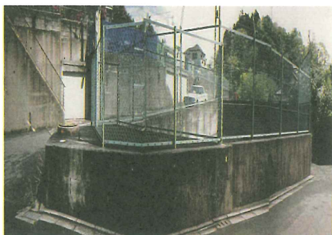
従前の防災調整池（約500m 3 規模）
