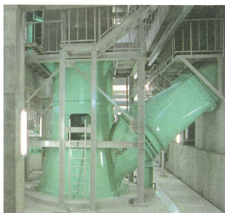
写-4 新内藤川主ポンプ
