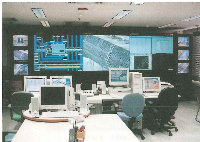
写-2 佐賀導水操作制御室（事務所）
