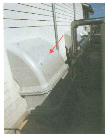
新内藤川主ポンプサイフォン配管
