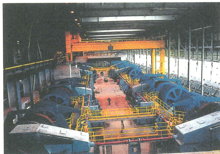
写-3 上部にある機械室
