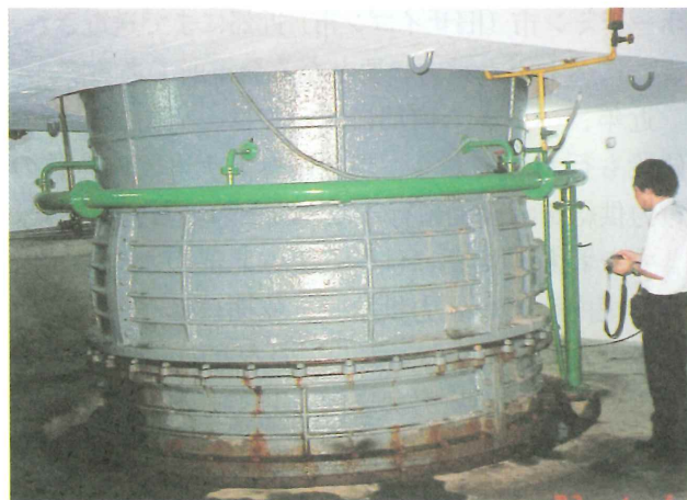
写-6 主ポンプ外観
