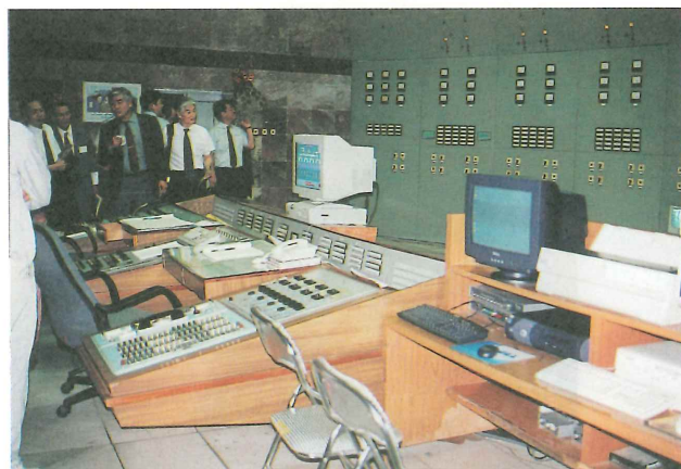
写-4 操作制御室
