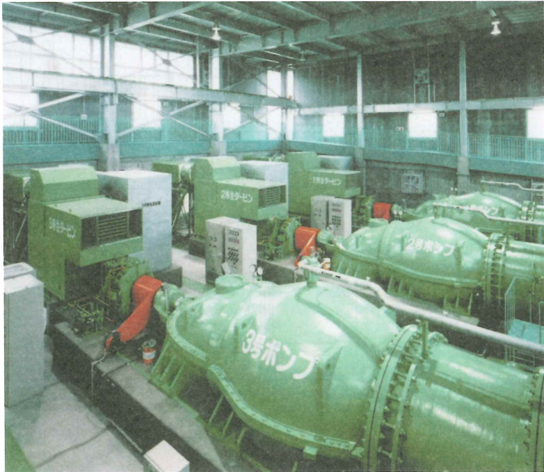
写ー4 ポンプ室内
