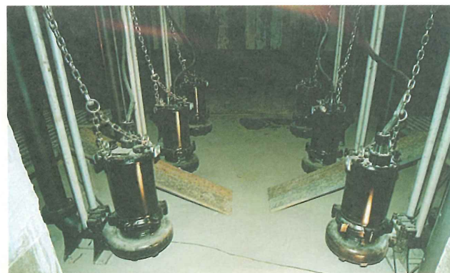
写-3 排水ポンプ
