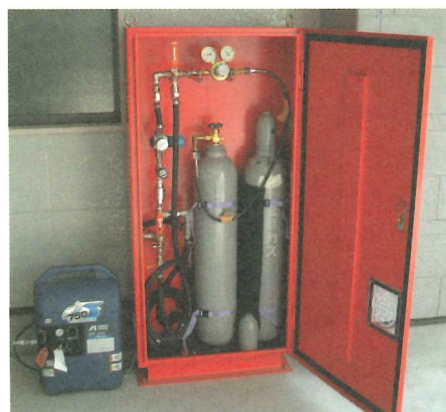
写一4 防水扉動力源及び操作盤 （左はコンプレッサー、右は窒素ガスボンベ）
