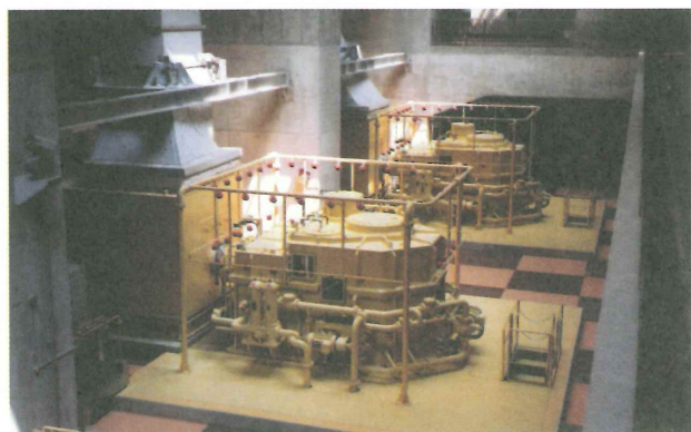
写一4 庄和排水機場・ポンプ設備
