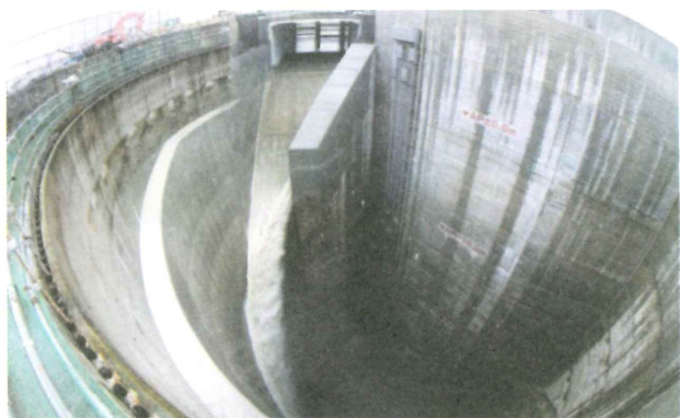
写一3 第3立坑・倉松川流入状況
