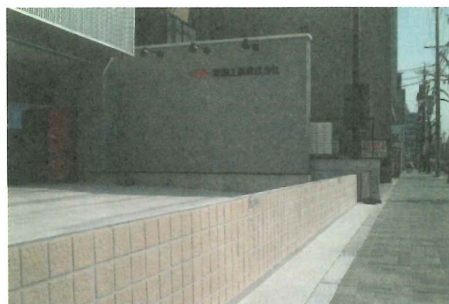
写一3 弊社名古屋営業所設置防水扉 起立状態 （止水幅9.5m×止水高0.5m）
