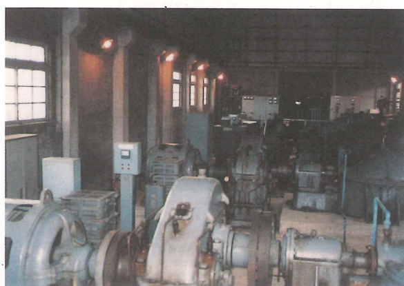
写-1 老朽化した大刀洗排水機場
