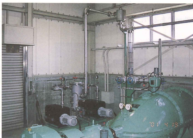
写-2 寒水川排水機場に導入した乾式真空ポンプシステム
