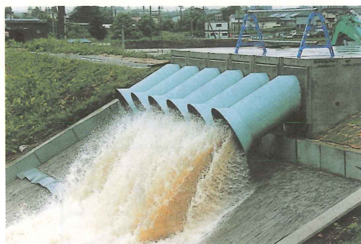
写－2 愛宕川救急排水ポンプ場の稼働状況
