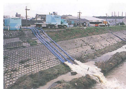
国道22号新川橋下流左岸での新川への排水状況
