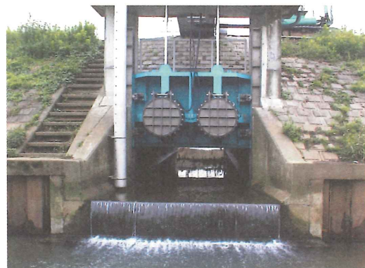
写-1 実機納入新型ポンプゲート
