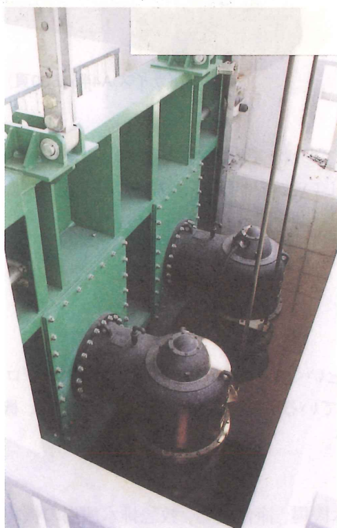
写一 立軸形ポンプゲート
