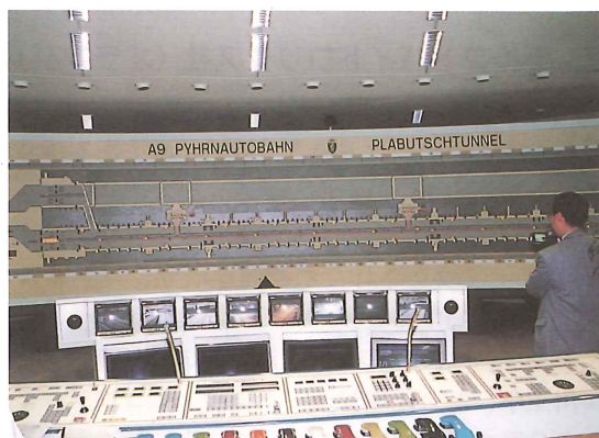
写-5 監視制御室
