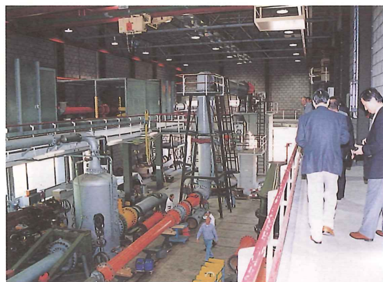
写-2 流量計測設備
