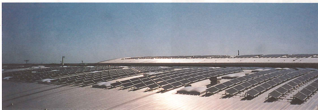
写-6 太陽光発電設備
