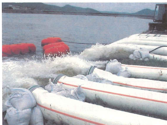
写-2 φ400mmホースからの排水状況
