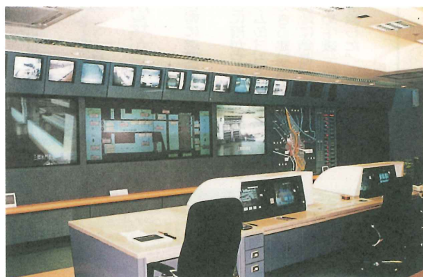
三郷排水機場操作室
