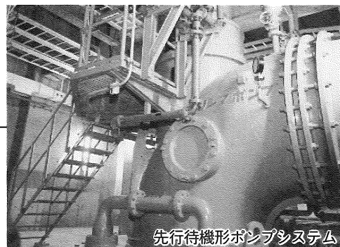
排水機場自動運転化システム、 広域監視制御システム
