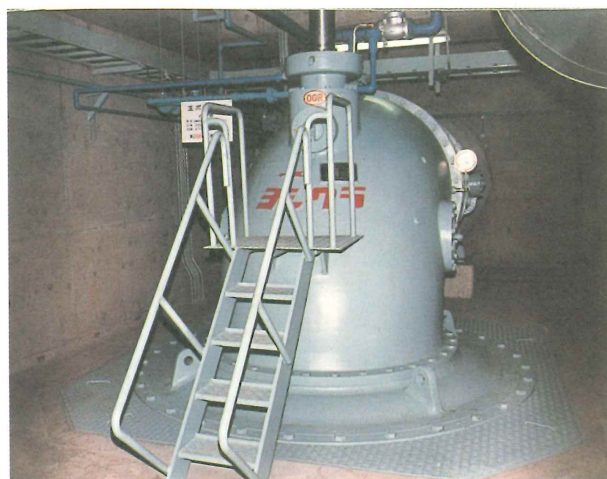
蓮花川排水機場ポンプ設備 φ1500立軸斜流ポンプ
