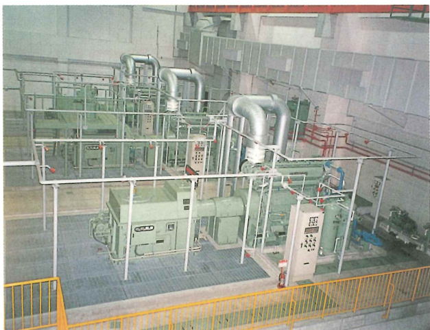
写-3 主ポンプ設備
