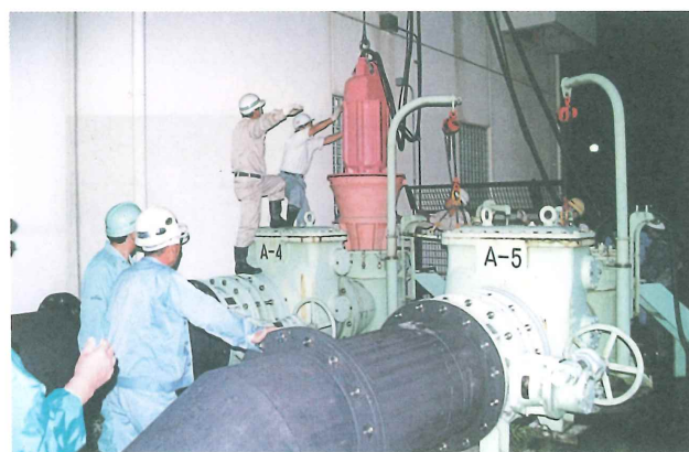
救急排水ポンプ設置状況
