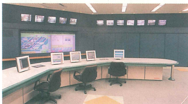
写ー2 中央操作室
