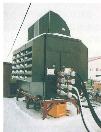
写-1 融雪用2熱源併用ヒートポンプ(30kW)
