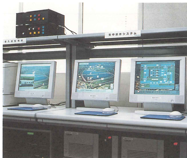
写ー1 集中操作システム
