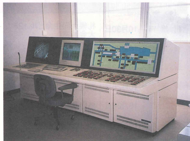
写一5 ポンプ設備広域監視・制御システム
