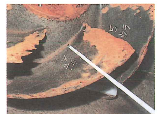
経年劣化した羽根
