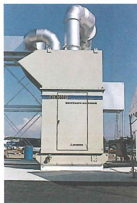
写-1 立型ガスタービンパッケージ外観
