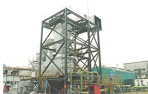
写-2 L型ガスタービン実証試験設備
