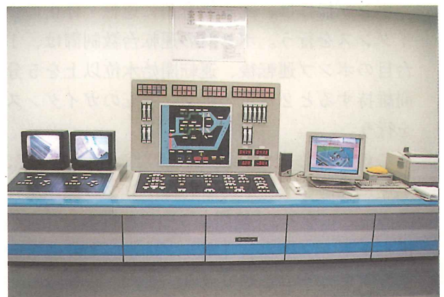
写一3 中央監視操作盤
