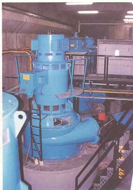
写-7 活躍する送水ポンプ
