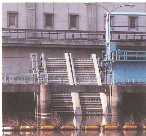
写-1 スクリーン循環式除じん機
