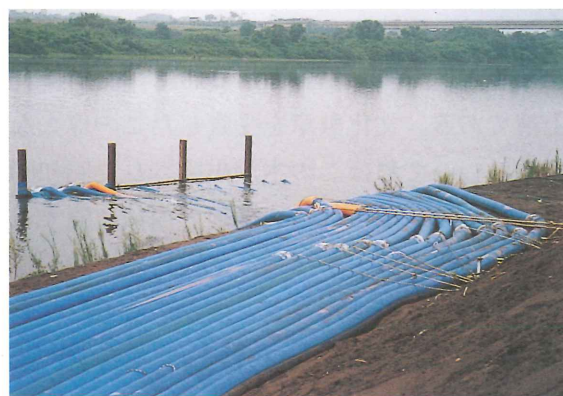
写-2 導水状況 (ポンプ部)
