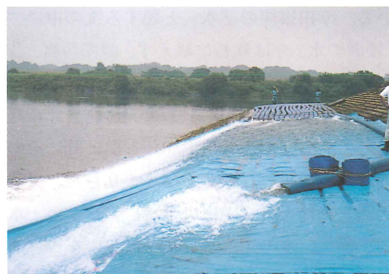
写-3 導水状況 (吐出部)
