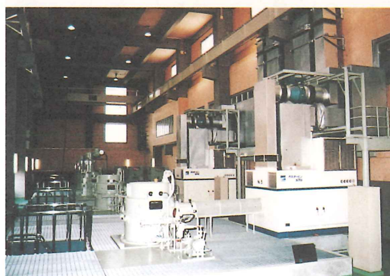
写－2 ガスタービン駆動軸流ポンプ
