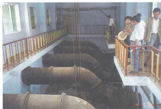
写-19 トン・ホイ・ニー村ポンプ場内の状況 主ポンプ：横軸軸流ポンプ 6台 主原動機：電動機 出力75kW
