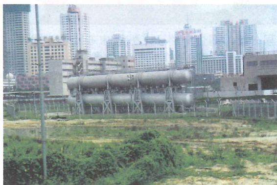
写-20 ムック・ウ・Cポンプ場 ポンプ場(右端)とウォーターハンマ防止用サージタンク 後方は中国との国境で深圳の高層ビル群がせまる。
