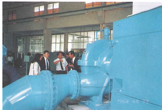
写－４ 送水ポンプ場調査の状況と主ポンプ設備
