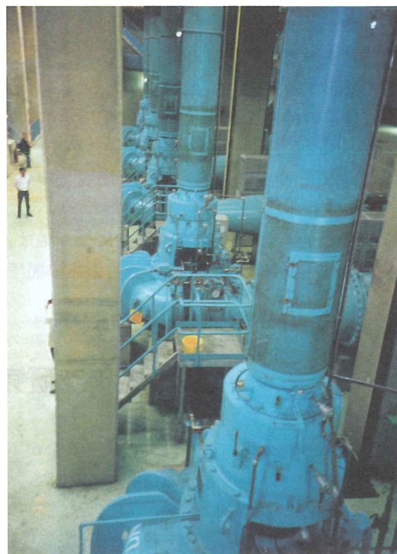
写-21 ムック・ウ・Cポンプ場主ポンプ設備 地下10mに10台が並ぶ姿は壮観。
