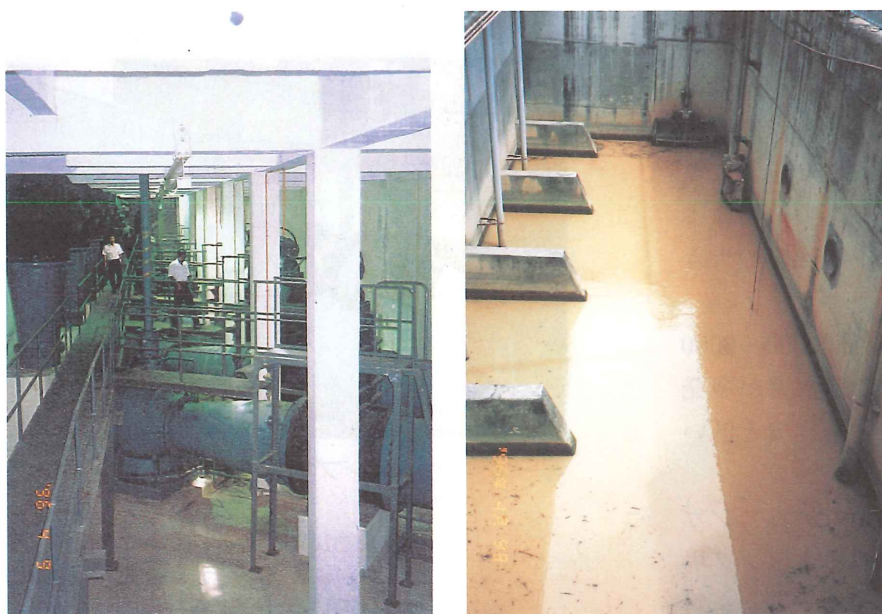
写－５ 取水ポンプ場、主ポンプ 設備と吸水槽の水質の状 況
