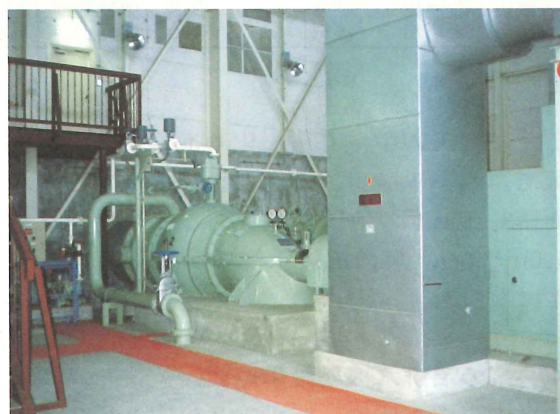
写-2 泉の沼排水機場の内部
