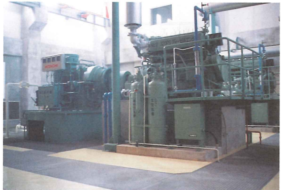
写-4 江見排水機場エンジン室
