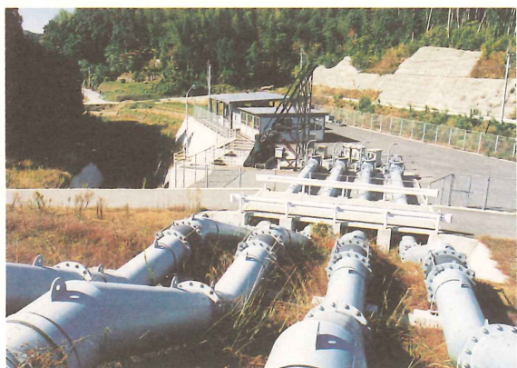
写－1 倉野救急排水機場
