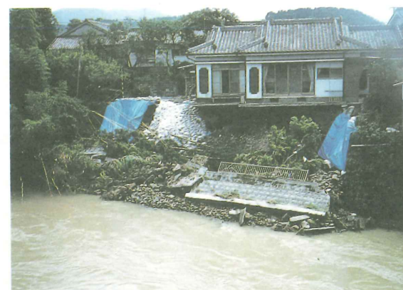
写一 3 川内川（8月豪雨、 鹿児島宮之城町）の被災状況
