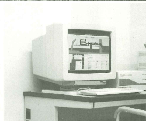
▲排水機場広域監視・制御システム
