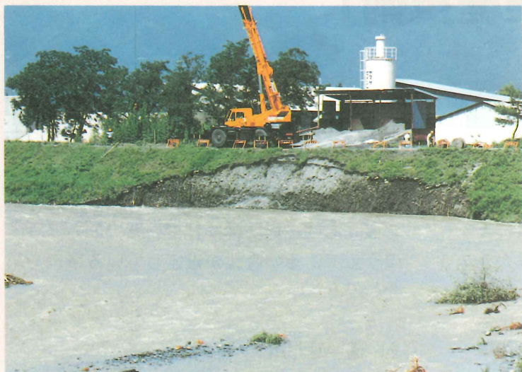
写一4 千曲川（梅雨前線、長野県松本市）の被災状況
