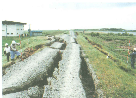
写一 1 北海道南西沖地震、後志利別川 （兜野築堤）の被災状況
