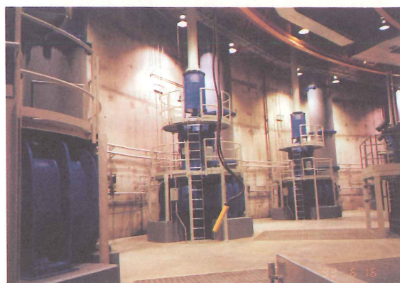
写－４ MUCポンプ室
