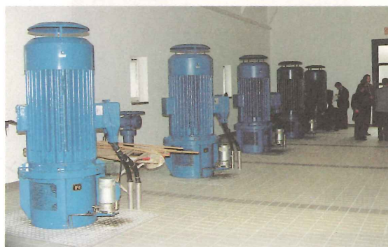
ディジェンドルフボーゲンバッハ排水機場 （ドイツ） 電動機フロアー
