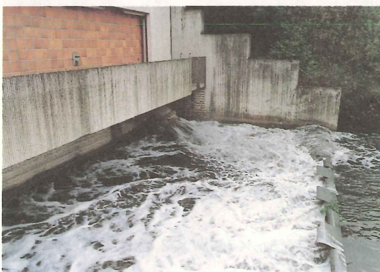
エムッシャー共同組合ハム排水機場（ドイツ） 吸水槽への戻り配管利用管理運転
