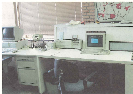
水管理公社管轄内のポンプ施設の管理用コンピュータ（カイゼルスバール排水機場・オランダ）
