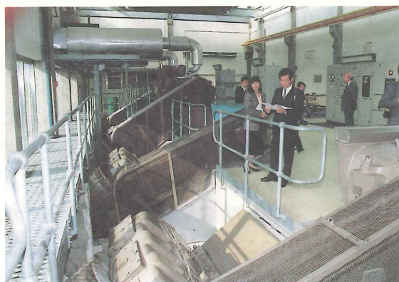
トリプコック排水機場（イギリス） スクリューポンプ2.13m 3 /s × 8.36m × 4 台 （エンジン駆動、電動駆動各 2 台）
