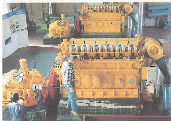
カイゼルスバール排水機場（オランダ） 9.3m 3 /s × 500ps × 3 台
