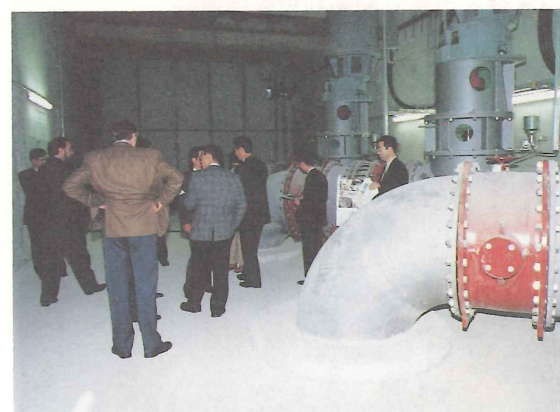
ルール水組合 カッセレルフェルド下水処理場 ポンプ設備 2.6\text{m}^3/\text{s} \times 10\text{m} \times 400\text{kW} \times 4 台
