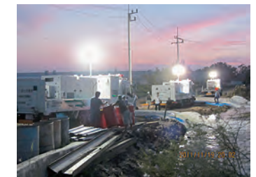
夜間の排水ポンプ車運転
