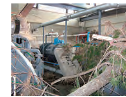
被災機場内部
