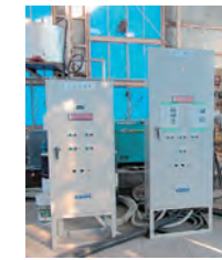
仮設操作盤による運転
