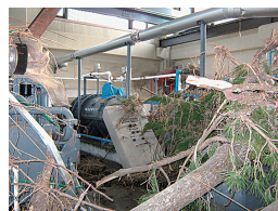
被災機場内部
