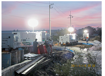
夜間の排水ポンプ車運転
