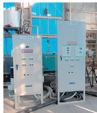
仮設操作盤による運転
