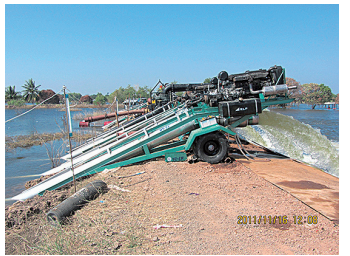
現地の移動式排水ポンプ
